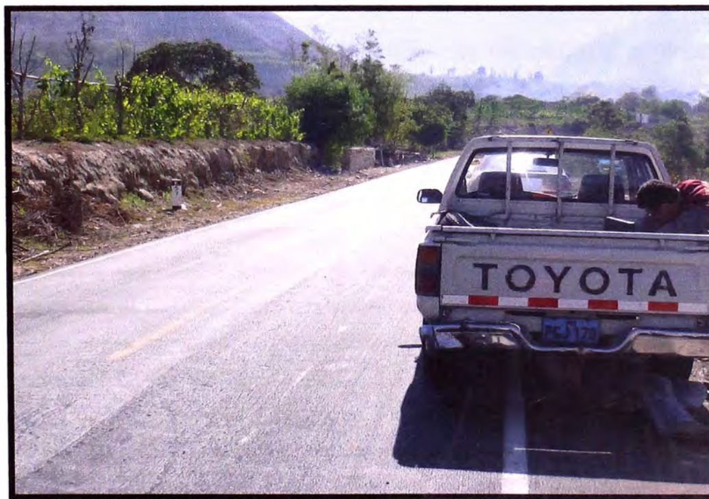
Figura N° 2.07: Instalación de Equipo Bump Integrator RETUBI
