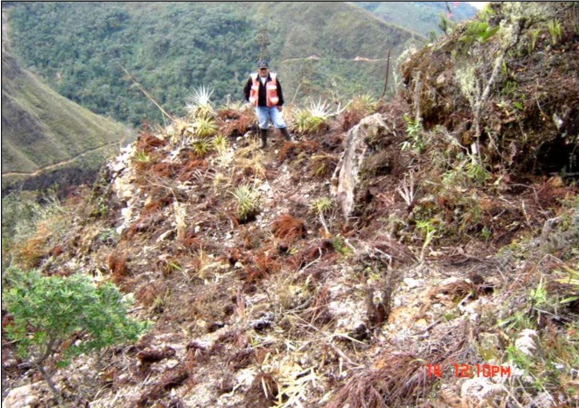
Fotografía N° 9. Vista de plataforma realizada en la campaña anterior la cual se encuentra rehabilitada.
