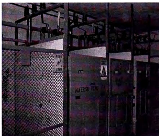
Celdas de Media Tensión Figura 2.2
