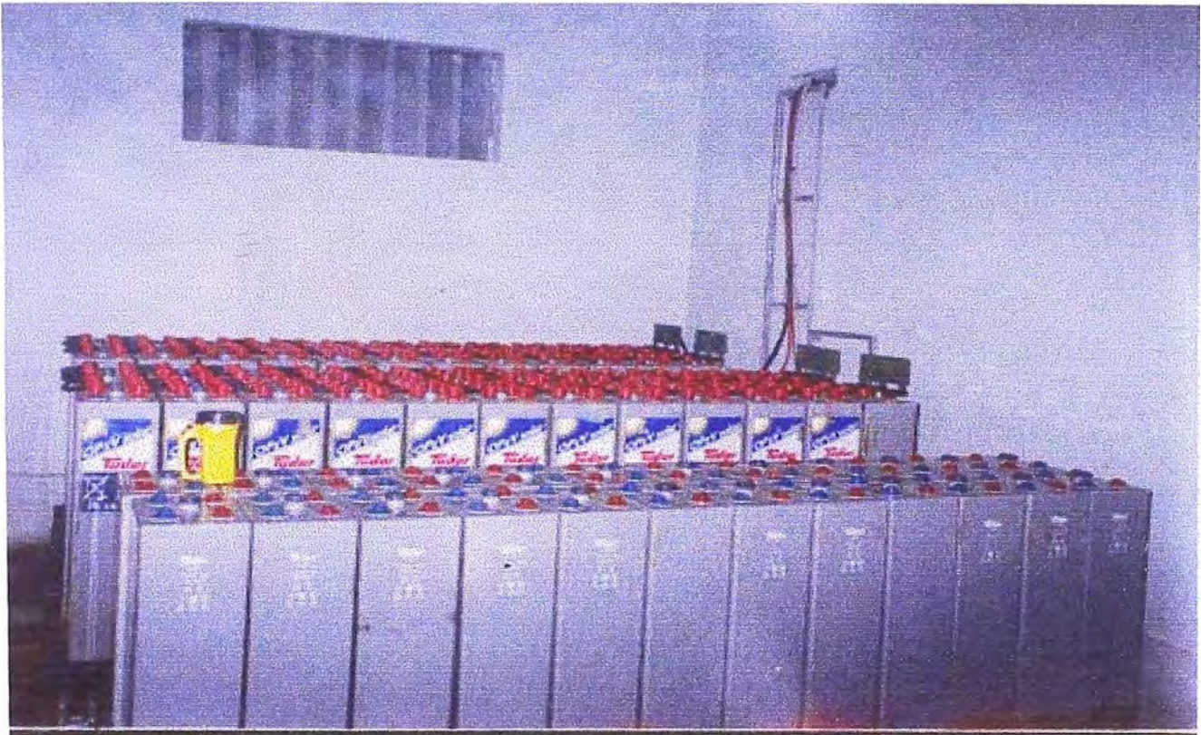
FIGURA 6 BANCO DE BATERIAS DEL SISTEMA HÍBRIDO FV-DO
