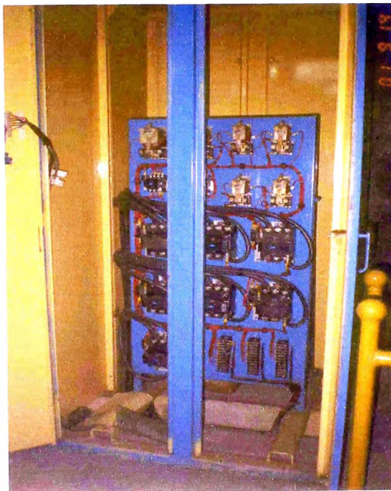
Figura Nro 3.15 : Panel de contactores secundarios
