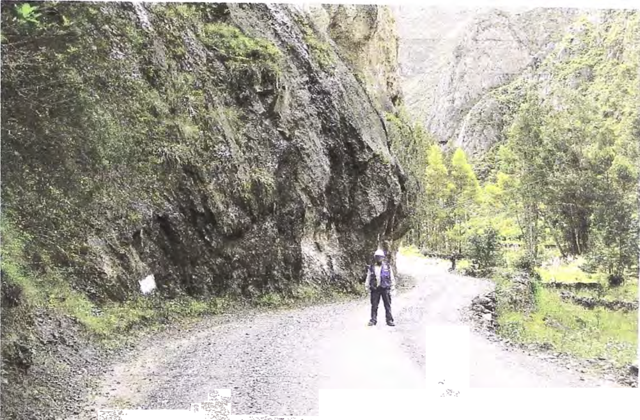
Foto N° 9: Se observa el ancho de calzada reducido en la curva, sin sobrecancho ni berma.
