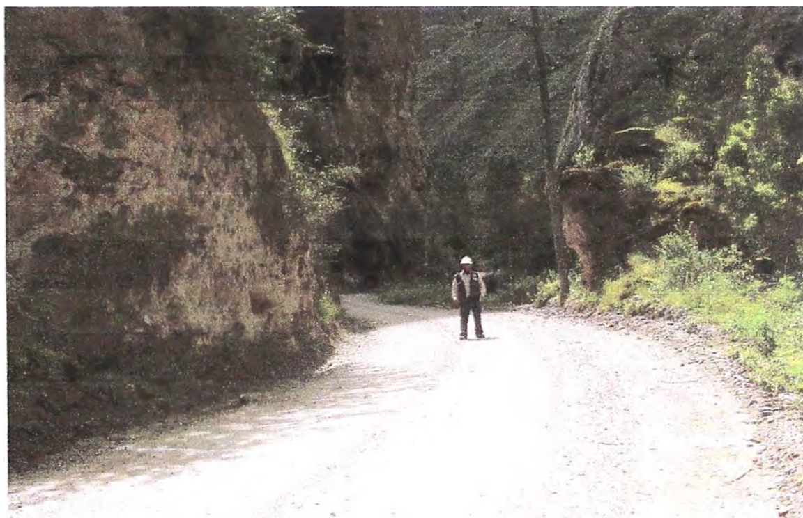
Foto N° 6: Se observa la falta de señalización ante la proximidad de una curva.
