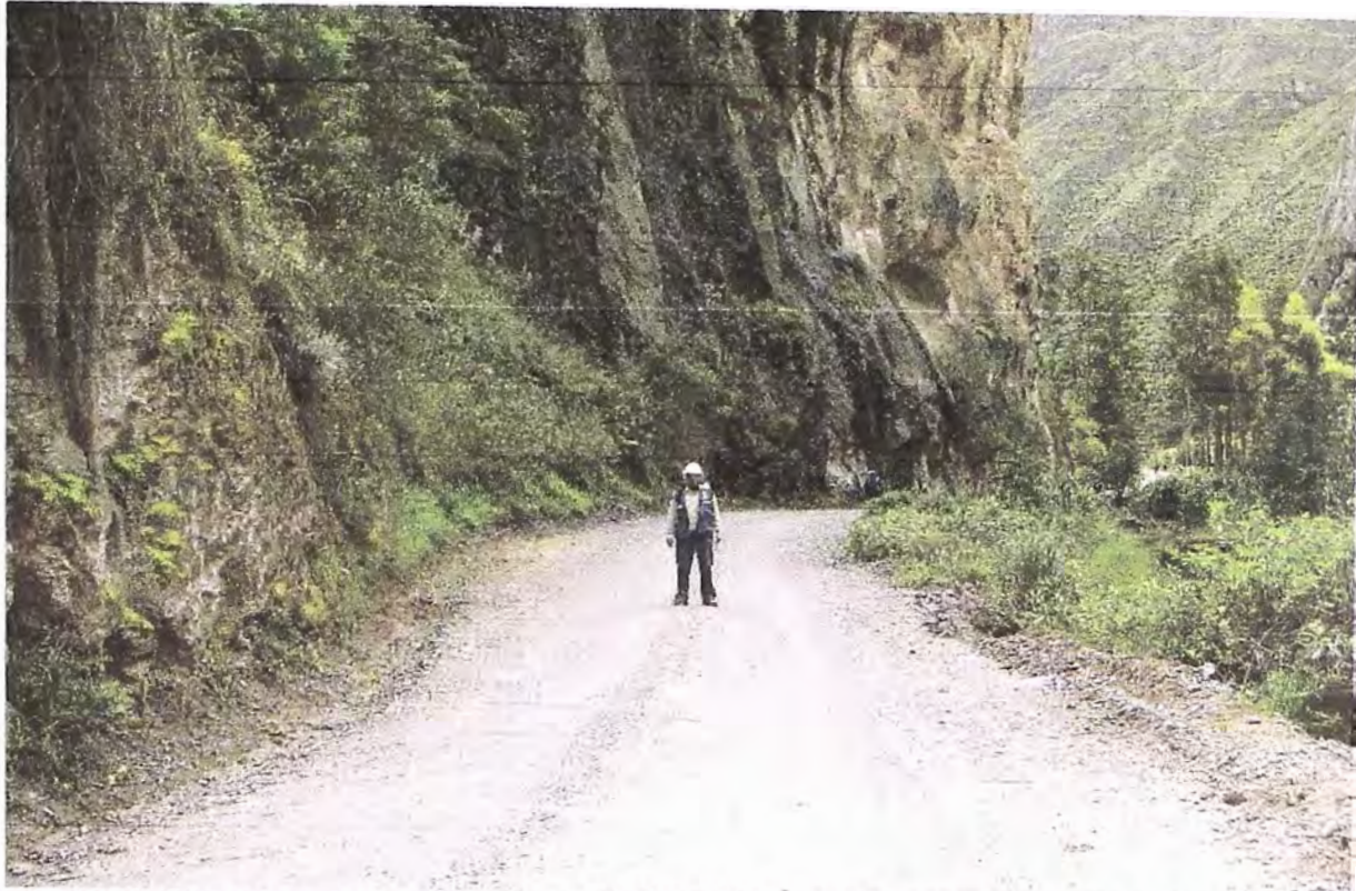
Foto N° 7: Se observa la falta de señalización ante la proximidad de una curva.
