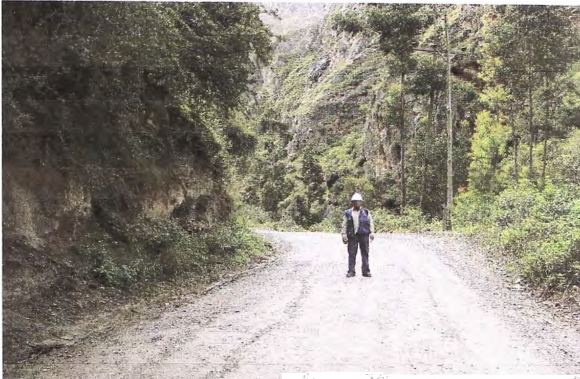
Foto N° 3: Se observa la falta de señalización que indique la proximidad de la curva.
