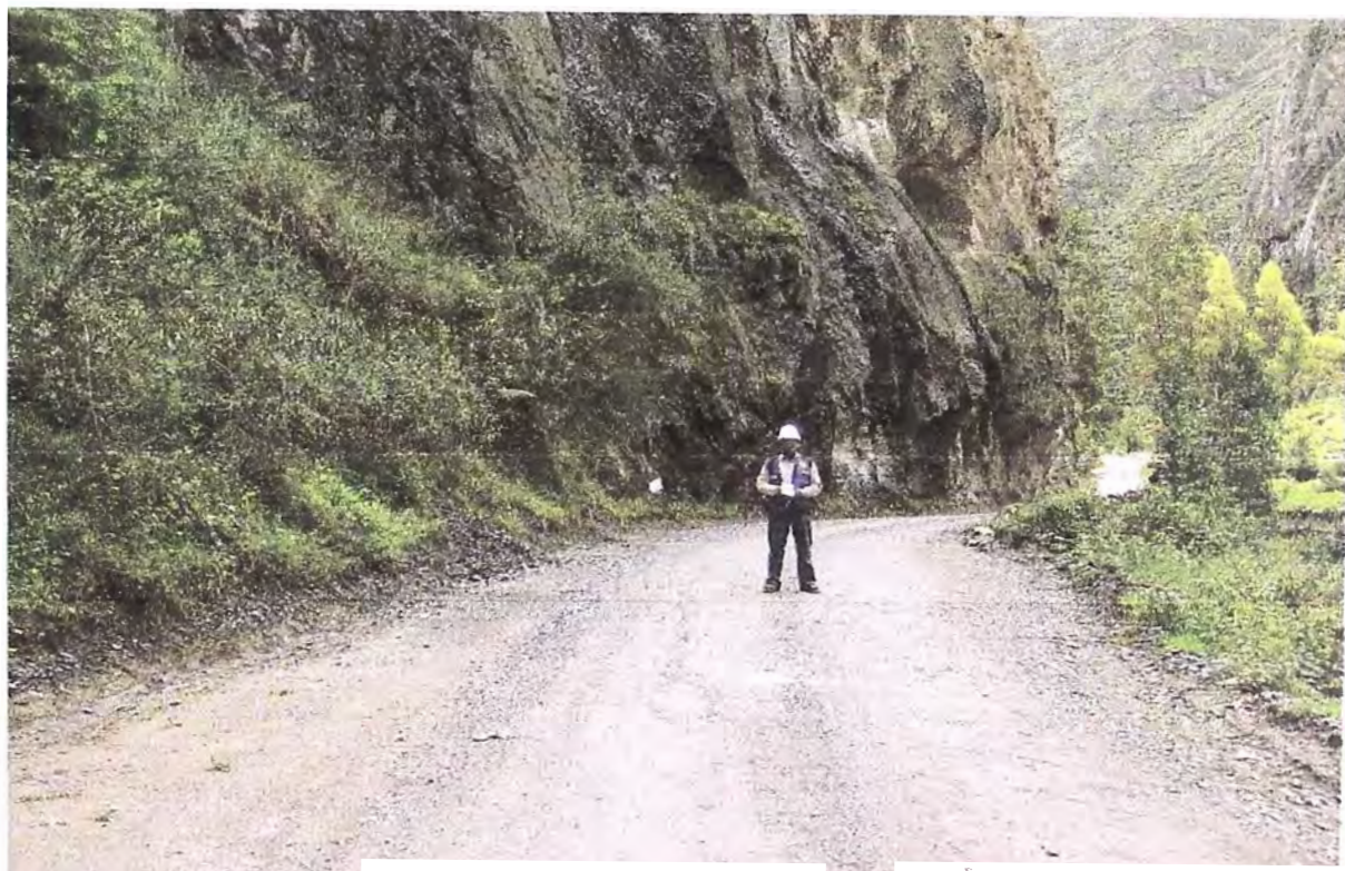
Foto N° 8: Se observa la reducción del ancho de la calzada por la invasión de la maleza al lado derecho.
