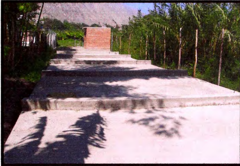
Figura 4.2: Estructura de captación en condiciones precarias por antigüedad.
