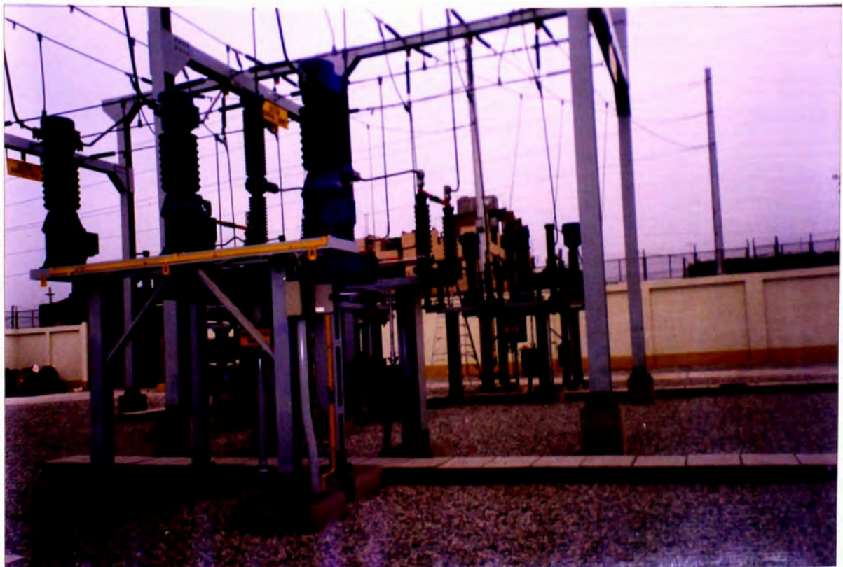
FOTOS DEL PATIO DE LLAVES DE LA SET
