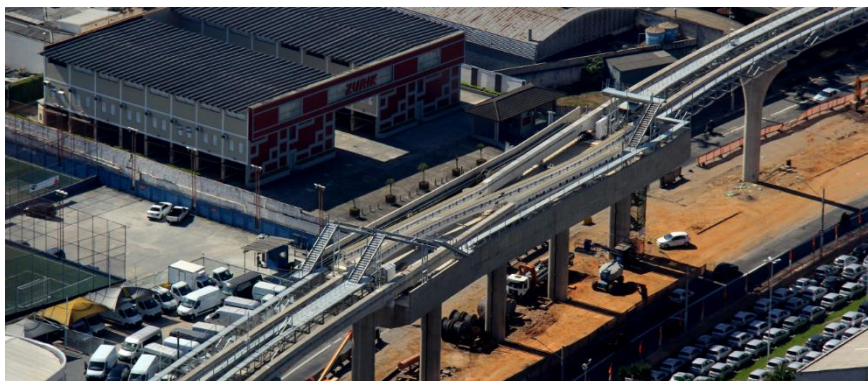
Figura N° 5.73 Intercambiador de vía - Monorriel
