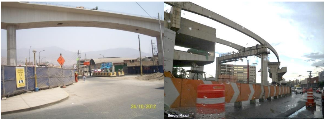
Figura N° 4.7 Señalización en Obra
