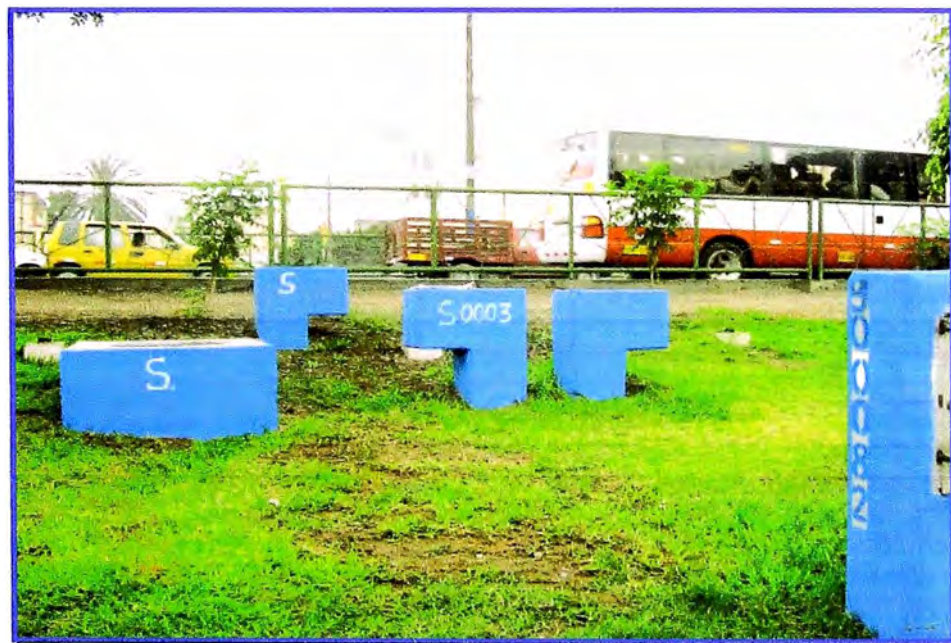
En esta imagen se observa la cámara de control SCADA del Sector S0003
