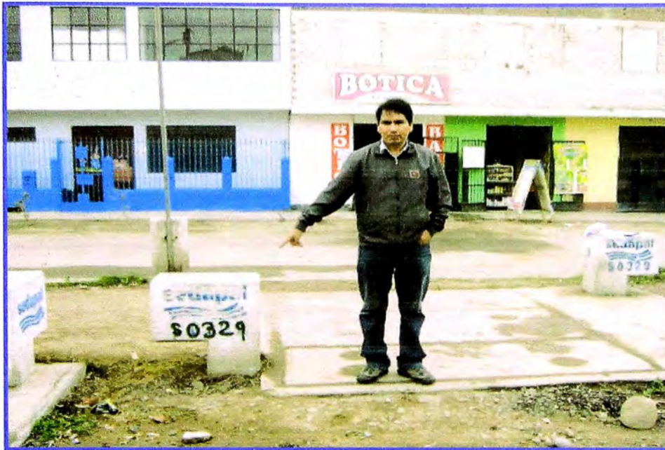
En esta imagen se observa la cámara de control SCADA del Sector S0329
