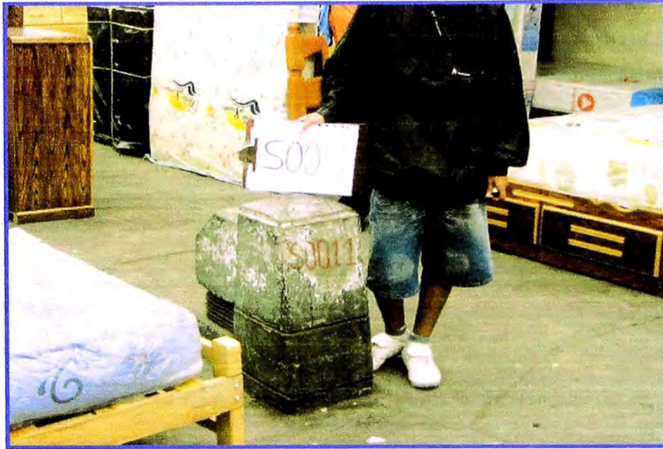
En esta imagen se observa la cámara de control SCADA del Sector S0011
