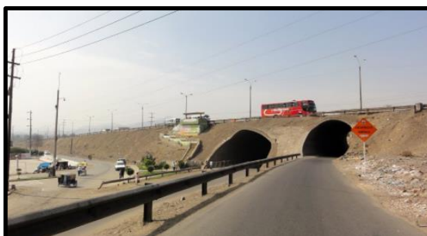
Figura N°A5.9 Puente Av. Antigua Panam. Norte con Av. Néstor Gambeta, Puente Piedra.
