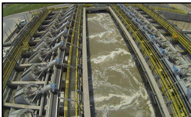
Figura N°A5.13 Fotografía de la moderna planta de tratamiento de agua en Puente Piedra -2014.
