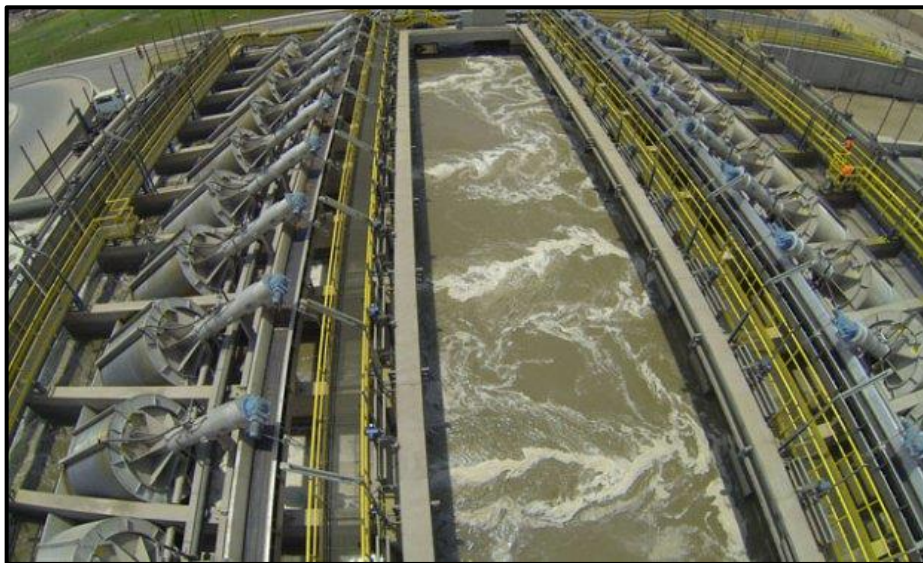
Figura N°5.2 Fotografía de la moderna planta de tratamiento de agua en Puente Piedra -2014.
