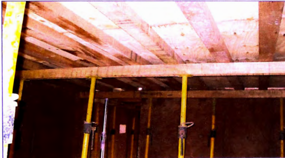
Fotografía 4.20: Diseño planteado para el encofrado de losa aligerada, con esto se buscaba disminuir el uso de puntales.
