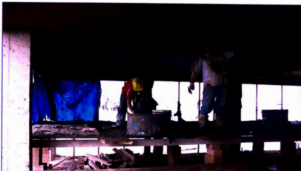
Fotografía 4.11: Frotachado final hasta obtener la superficie deseada, también se observa el recojo de mezcla por parte del ayudante.
