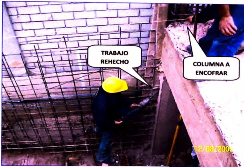
Fotografía 4.17: Los trabajos rehechos originaban demoras durante el inicio de la jornada, en este caso retirar una solera atrapada por el concreto endurecido.
