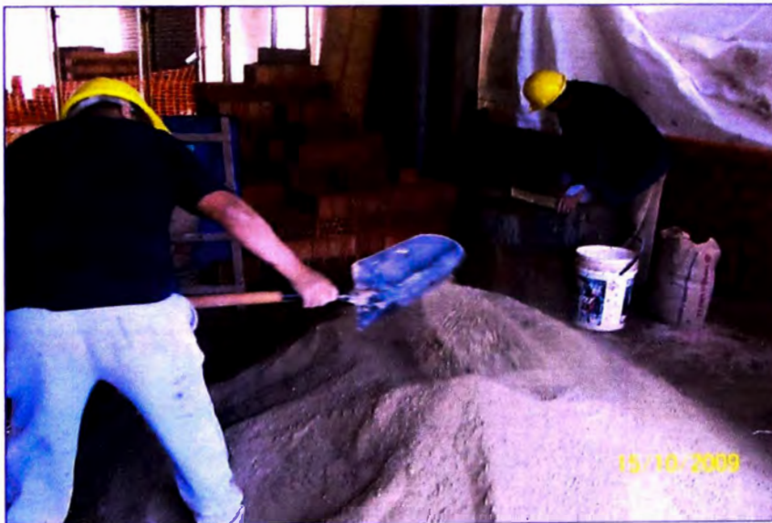
Fotografía 4.9: Preparado de mortero por parte del ayudante para el asentado de ladrillos.
