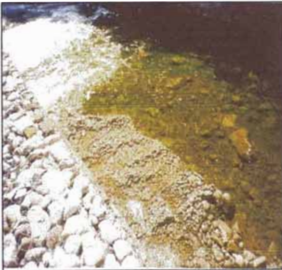
Socavamiento a pie del espigón. Se observa la remoción de las piedras que servían de protección.
