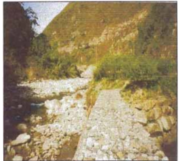
Vista aguas arriba del espigón. Se observa una curva cerrada motivo por el cual existe una socavación local.
