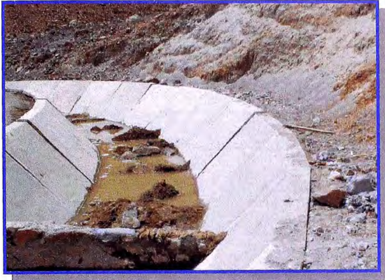
Vista de uno de los tamos en mal estado
