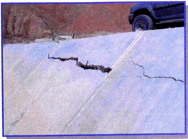
Se observa grietas de las losas de hasta 5 cm.
