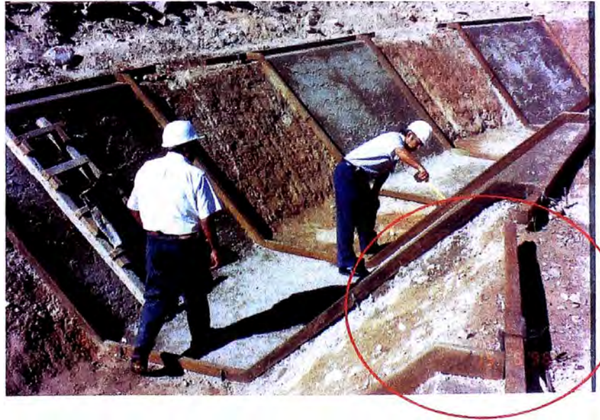
Zona sin geosinteticos, preparación para el vaciado del concreto de regularización, se observa inicio de zona en curva
