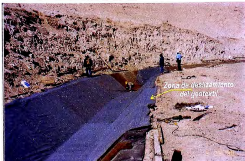
Colocación de la manta de Geotextil, no se aprecia ningún tipo de anclaje temporal para la colocación de la manta.
