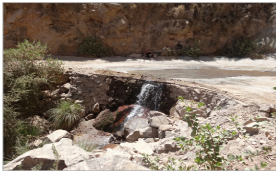
Figura N°2.4 Progresiva Km 140+800, falta de Encausamiento. Fuente: Expediente Técnico Moquegua – Omate.
