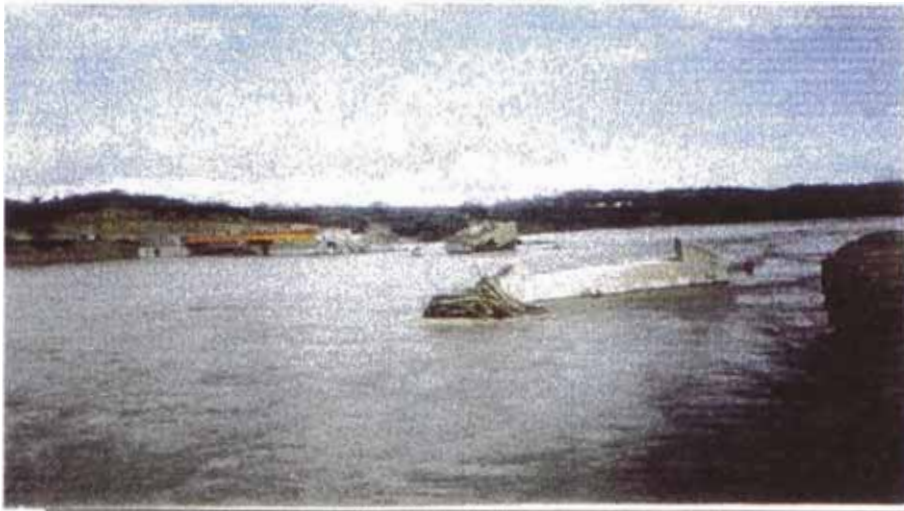
Puente Franco - Perú, socavación y falla de pilares y estribo derecho
