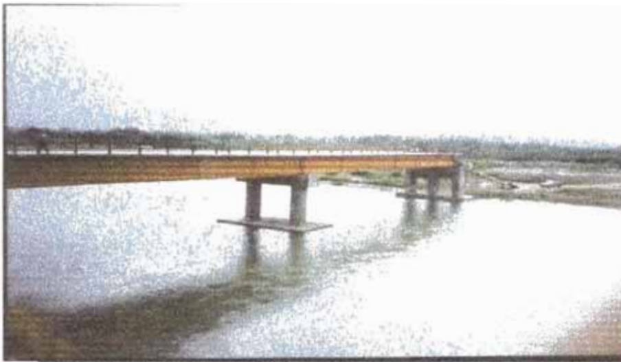
Puente Franco - Perú, después de máximas avenidas, sólo 2 tramos quedaron en servicio
