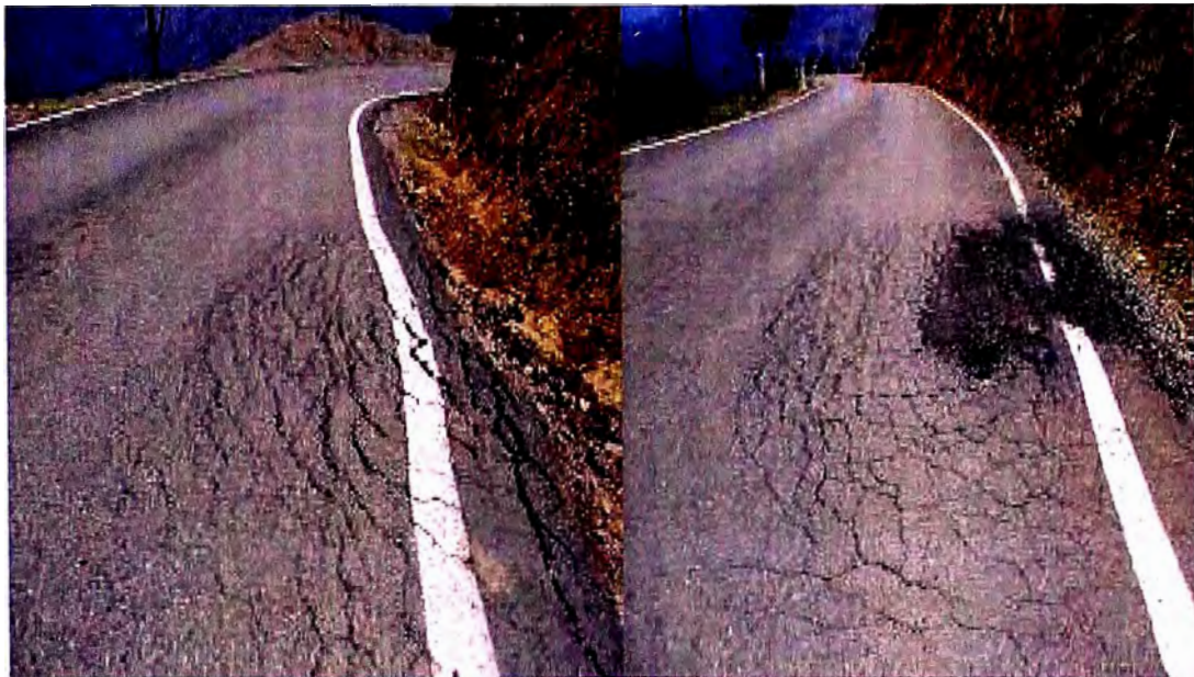
Figura N° 67 Problemas Geotécnicos (km.183+934)
