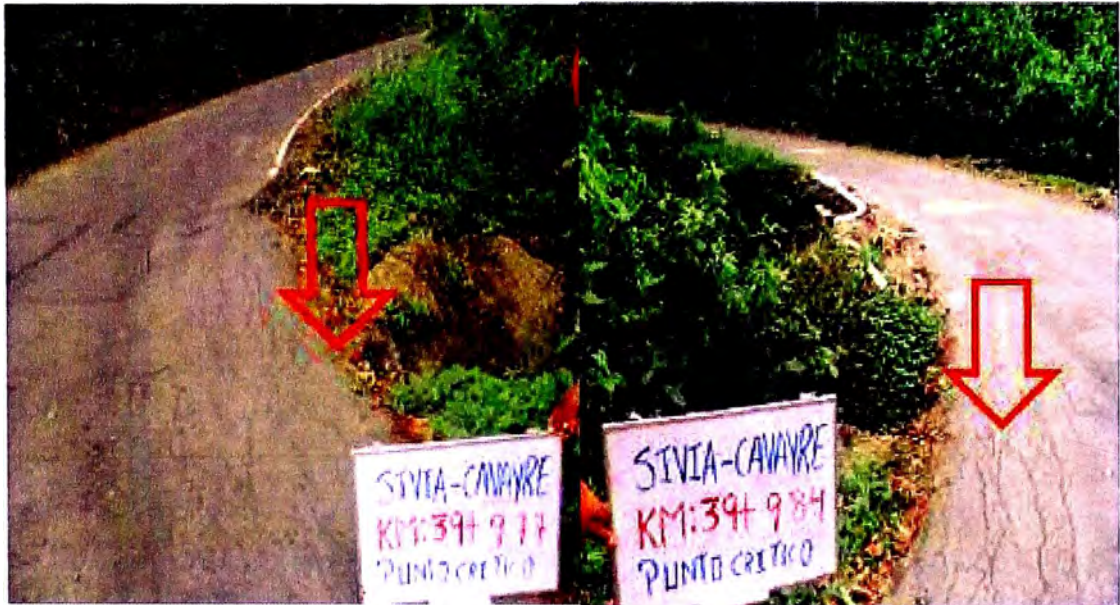
Figura N° 81 Asentamiento del talud inferior.
