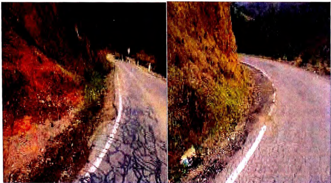
Figura N° 66 Problemas Hidrológicos (km.185+234-km.185+341)
