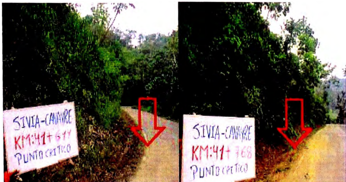
Figura N° 80 Problemas Hidrológicos por falta de drenaje superficial.
