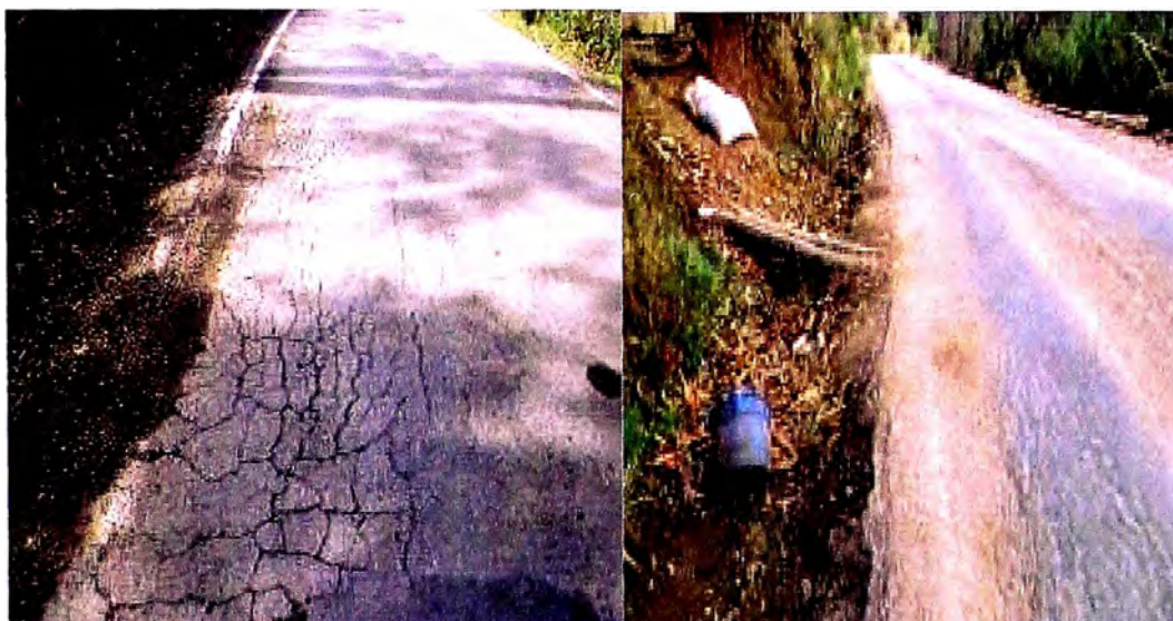
Figura N° 62 Problemas Hidrológicos km.176+463 al km.176+590.
