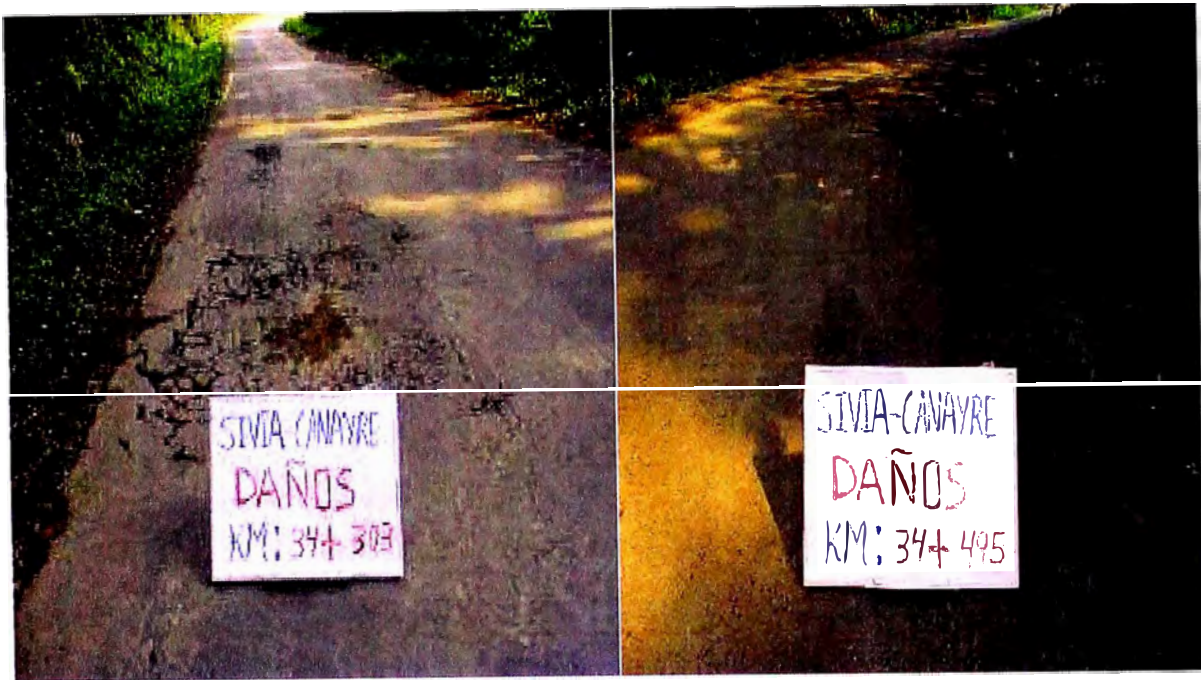
Figura N° 77 Falta de drenaje profundo
