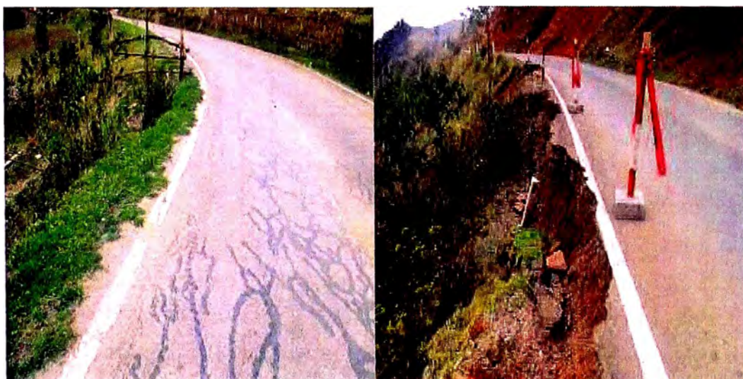
Figura N° 63 Inestabilidad de talud inferior (km.168+00 al km.174+600)
