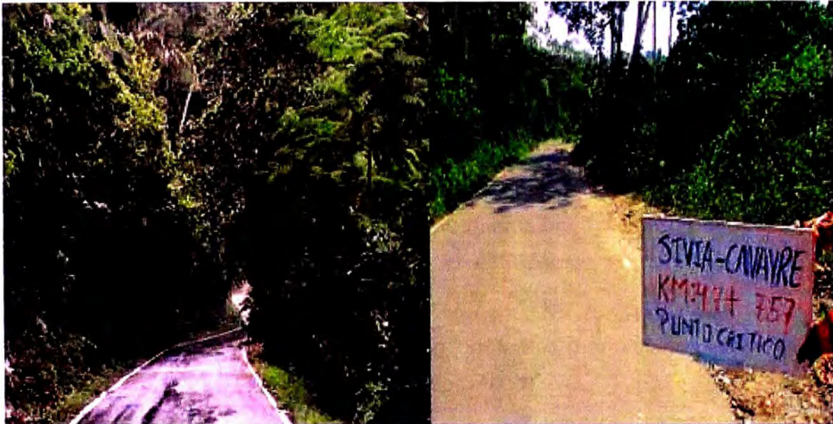
Figura N° 88 Problemas Hidrológicos Tramo Sivia Canayre
