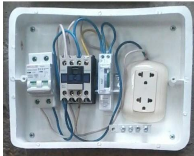
Fotografía 10.6 Caja de llaves eléctricas
