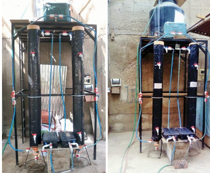
Fotografía 10.5 Ubicación inicial y final de los filtros en la zona de tesis 2
