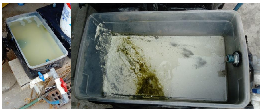
Fotografía 6.2 Sedimento acumulado en sedimentador de efluente de Filtro F 1
