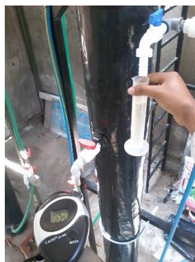
Fotografía 10.15 Aforo a la salida de los Filtros
