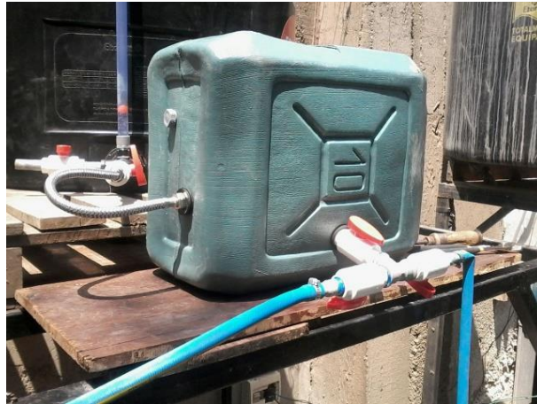
Fotografía 10.7 Sistema de válvula flotadora para un caudal constante.
