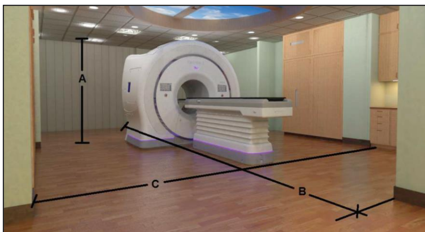
Figura 5: Dimensiones de la sala de tratamiento que se evalúan para saber si se puede instalar en él un equipo de tomoterapia [4].
