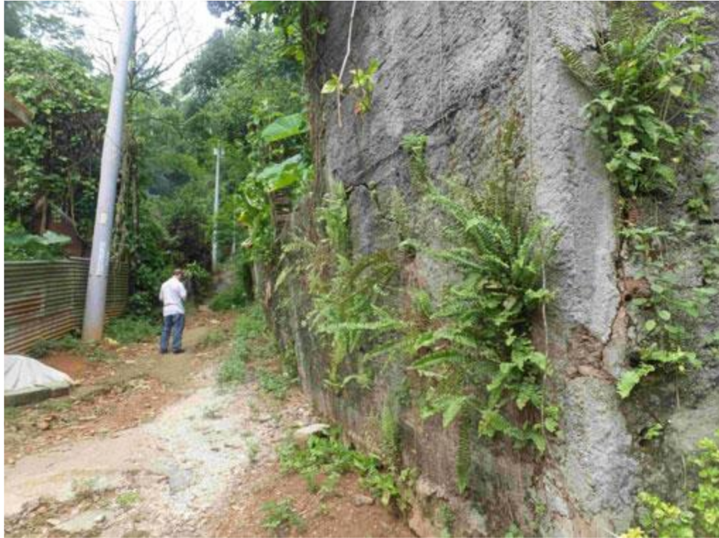
Figura 4.17. Muro dañado por los movimientos ocurrido en la “zona en análisis”.
