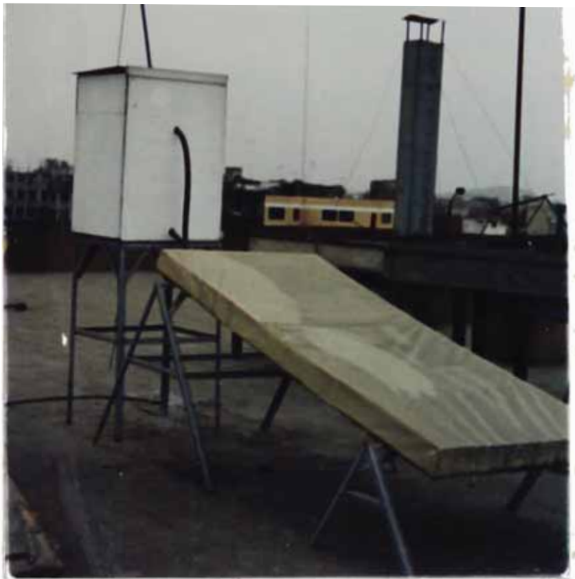
FIG. #4: TERMA SOLAR, en el cual se uso el ADATOC para medir varios puntos de TEMPERATURA.
