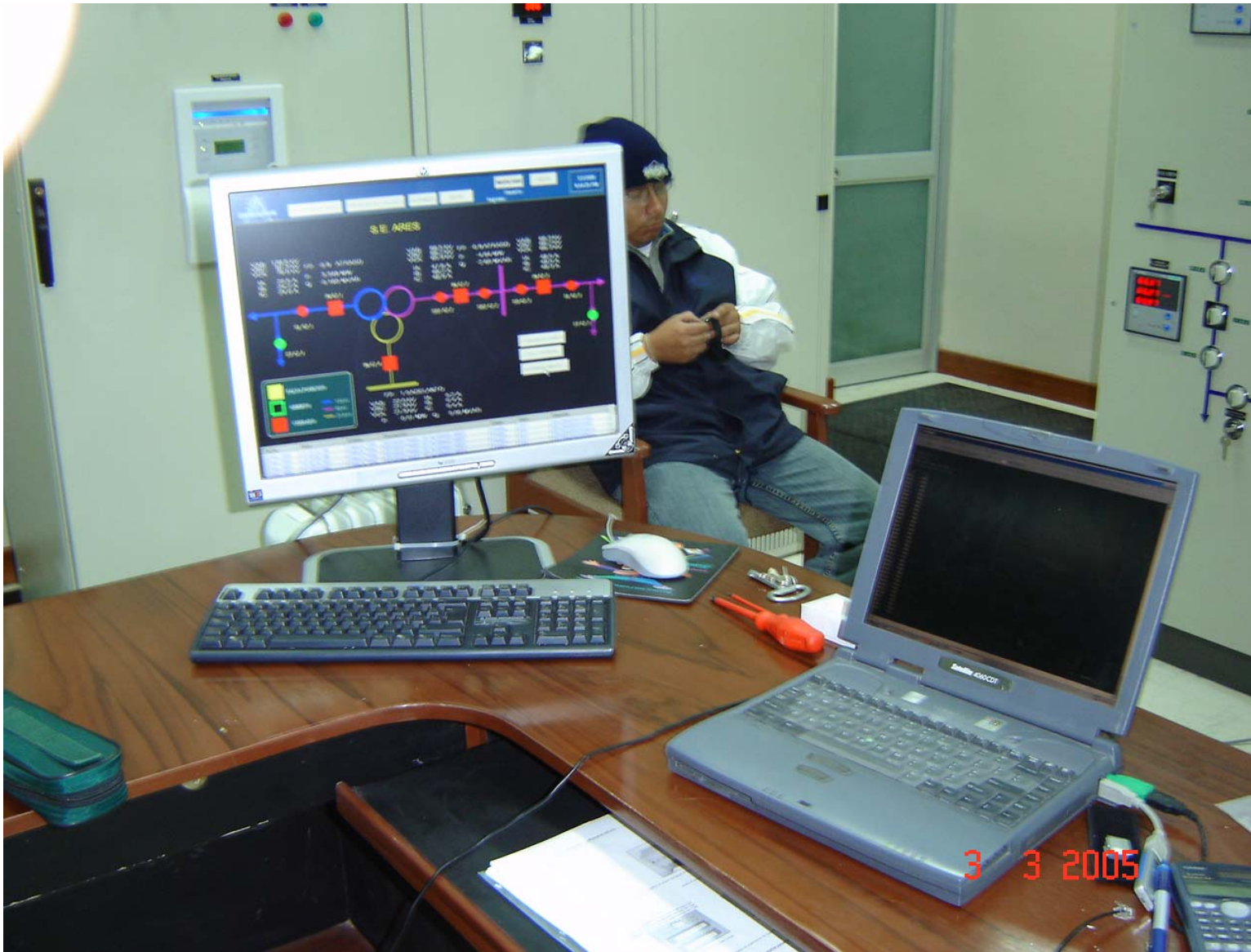
Figura 3.7 HMI, subestación Ares
