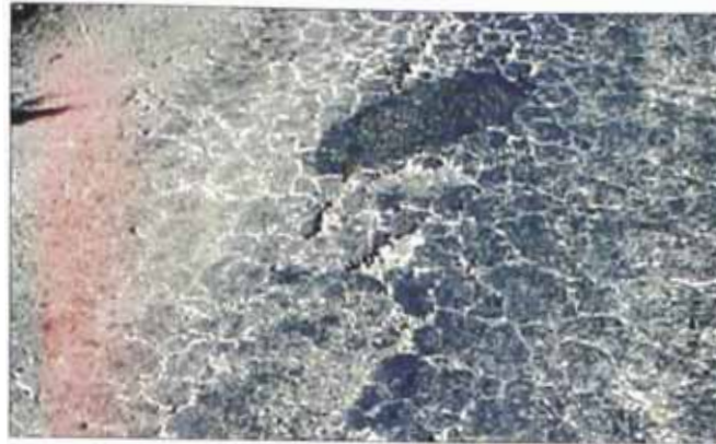
Figura 6.3.- Agrietamiento Piel de Cocodrilo
