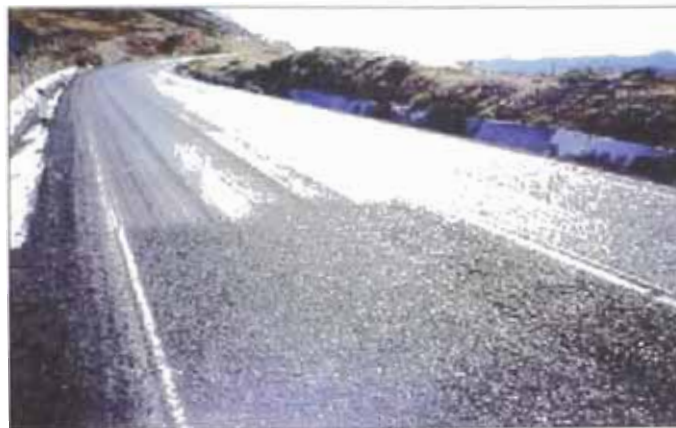
Figura 6.4.- Desgaste superficial moderado
