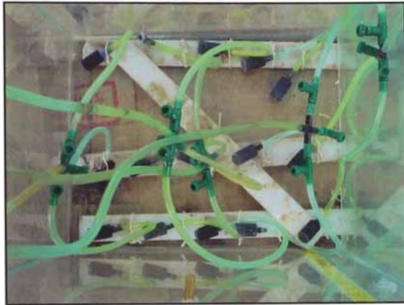
Foto N° 4.19: Vista de Bateria de Difusores Porosos, de arriba para abajo
