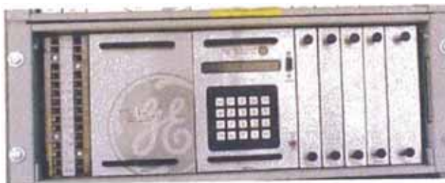
Figura V.8. Relé DLP donde se observa donde va el peine de pruebas.
