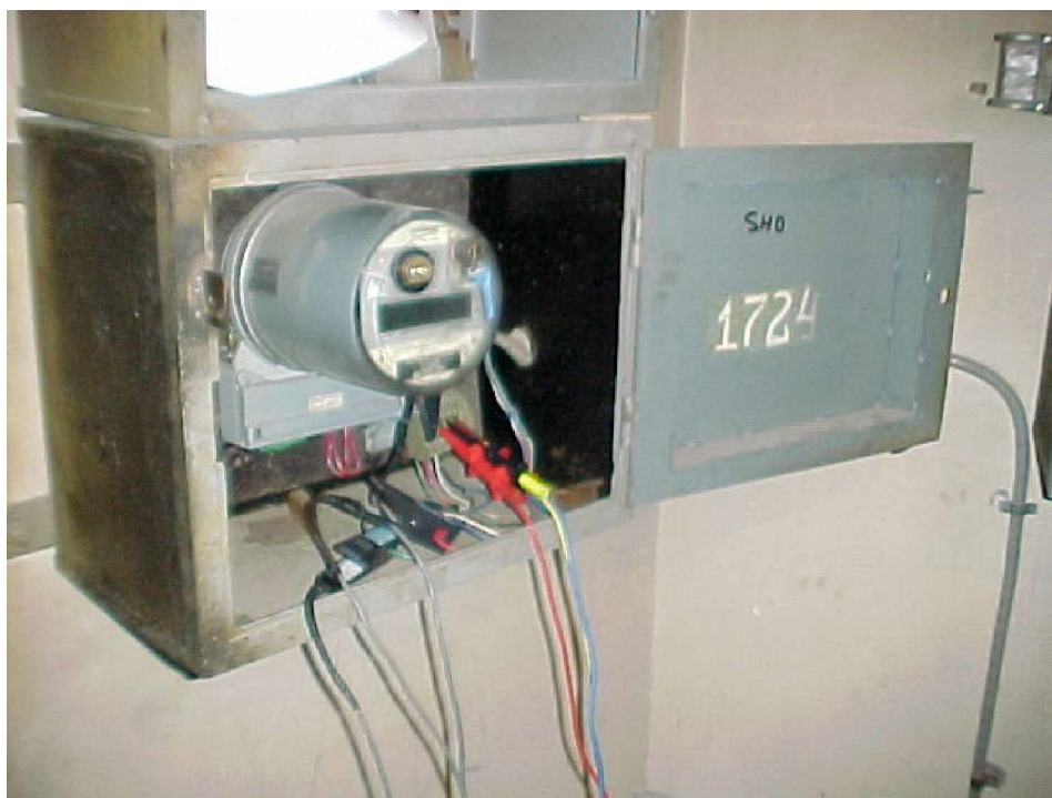
Figura 5.7 Punto de venta de energía y punto también de instalación del equipo de medición.
