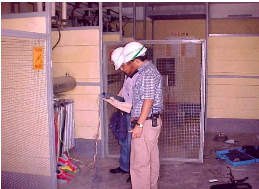
Figura 5.6 Instalación de equipos analizadores de calidad
