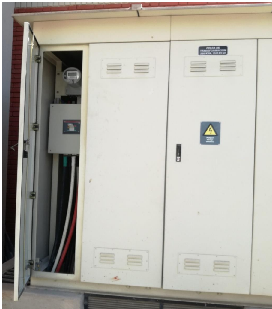
Figura 8. Vistas de la subestación de la facultad de ingeniería ambiental
