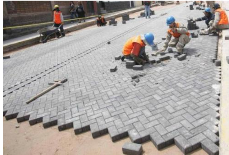
Figura 3.9 Adoquinado en vías interiores de la Universidad Nacional de Ingeniería, Lima-Perú - https://www.google.com
