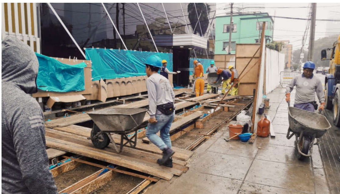
Vaciado de veredas para los estacionamientos como parte de las obras exteriores. Al fondo la marquesina de ingreso por la calle Jazmines
