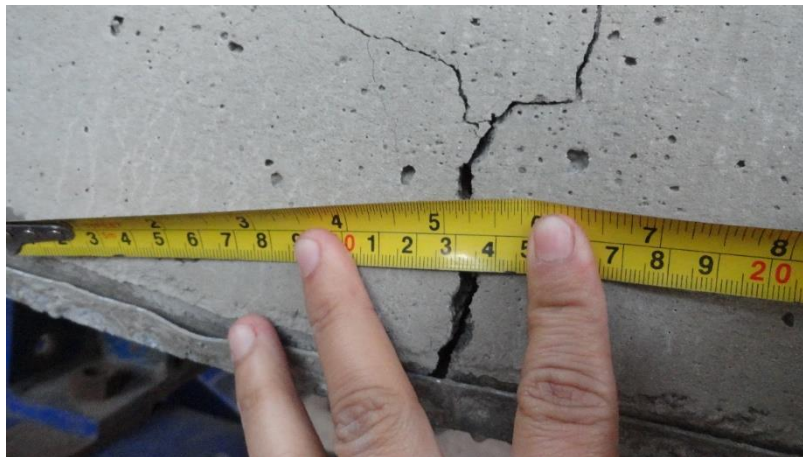
Figura A.11 Grieta diagonal producida en el punto de aplicación de la carga.
