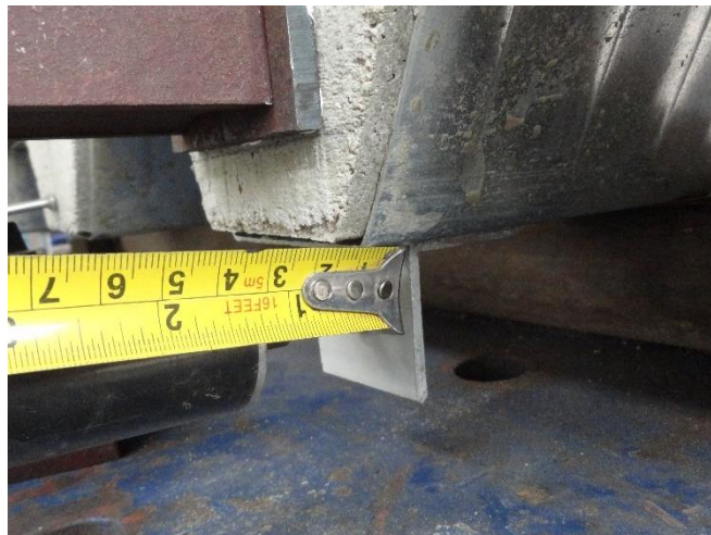
Figura N° 2.16 Separación vertical en el extremo de la losa.
