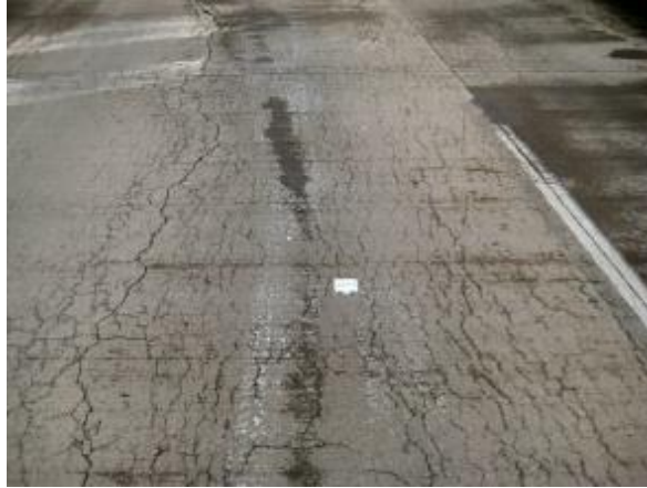
Figura N° 3 Patrón de fisuración RAS en un pavimento de carretera (U.S. Department of Transportation,2013)
