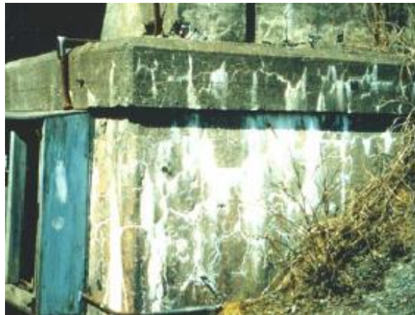
Figura N° 8 Eflorescencia y exudación de gel álcali-sílice en la superficie del concreto de una cimentación de puente afectada por RAS (U.S. Department of Transportation,2013)
