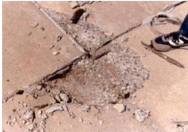
Figura N° 6 Expansión causando desprendimiento de juntas asociadas con la RAS (U.S. Department of Transportation, 2013)
