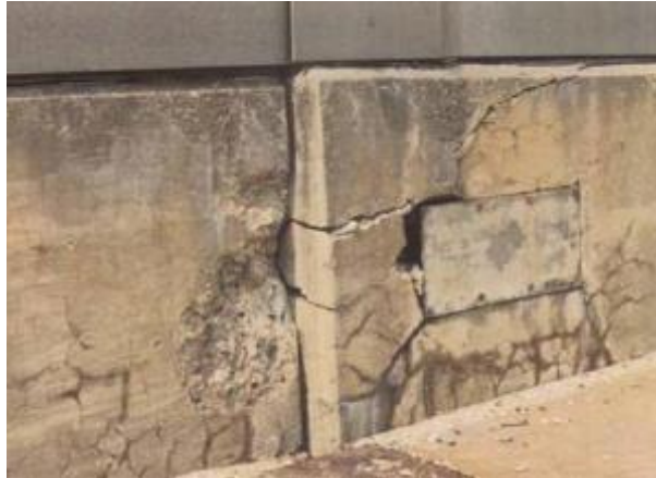
Figura N° 5 Movimiento relativo en una estructura de puente afectada por RAS (Stark, 1991)
