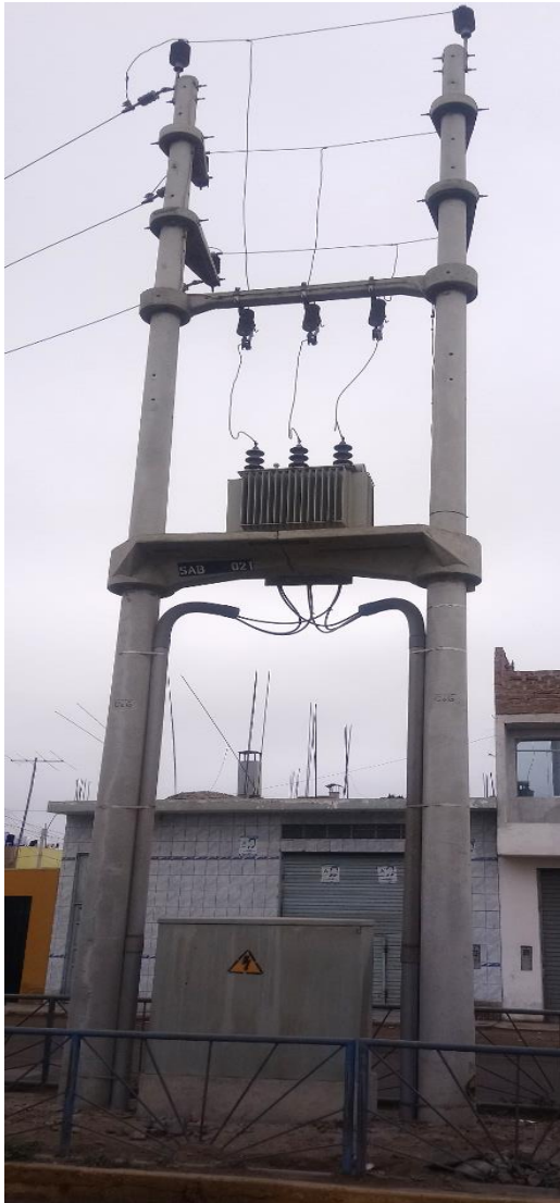
Figura N° 36 Subestación Aérea Biposte (SAB)
