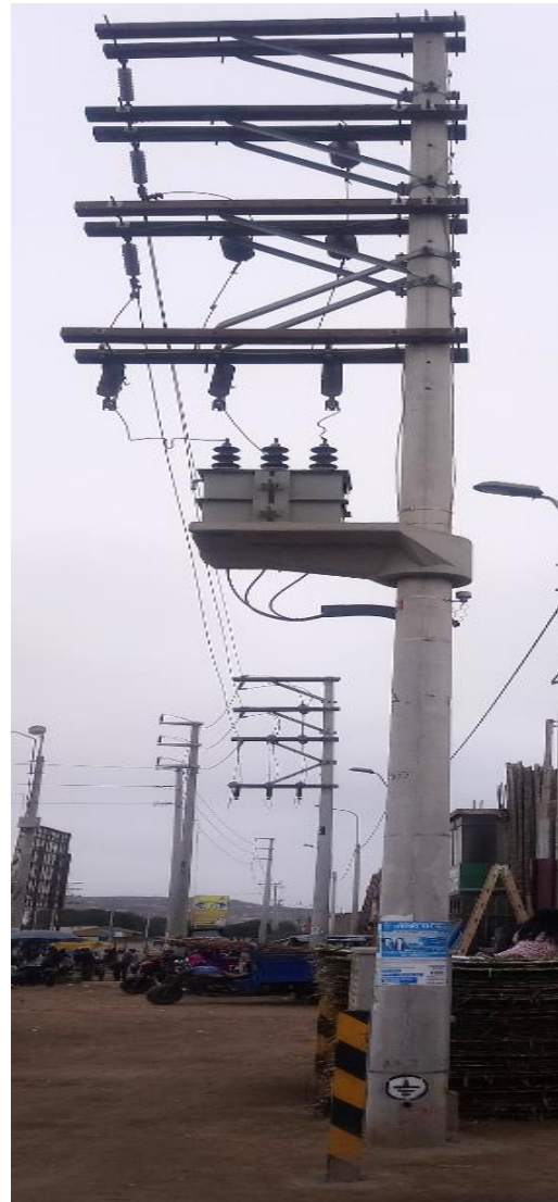
Figura N° 37 Subestación Aérea Monoposte (SAM)
