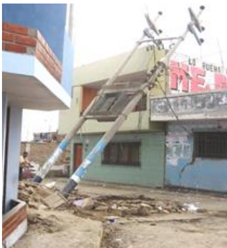
Figura N° 77 SAB luego del sismo en Pisco el 15 de agosto de 2007
