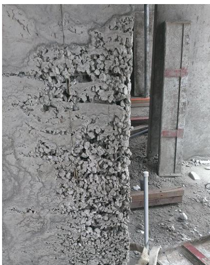
Figura N° 34. Muro con cangrejera.
