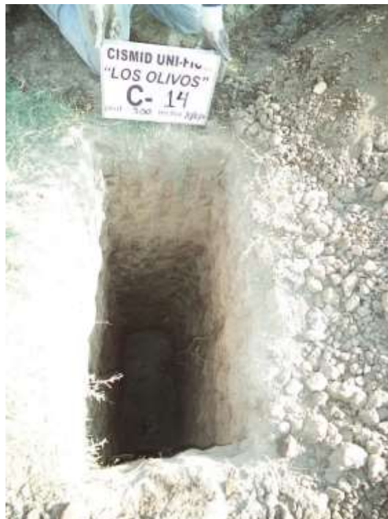
FOTO 28: En la calicata C-14, de 0.00 a 1.20 m se tiene relleno; de 1.20 a 2.20 m arcilla delgada con arena (CL); de 2.20 a 3.00 m grava mal gradada con arena (GP).
