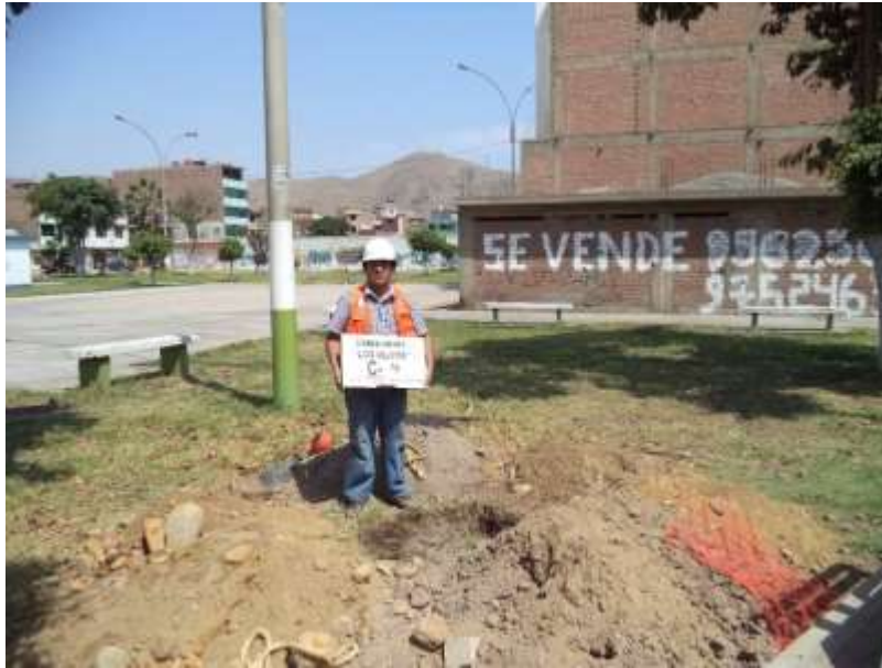
FOTO 7: Calicata C-04, ubicada en parque cerca de la Av. Universitaria, coordenada UTM: 273194.00 m E y 8673166.00 m N.
