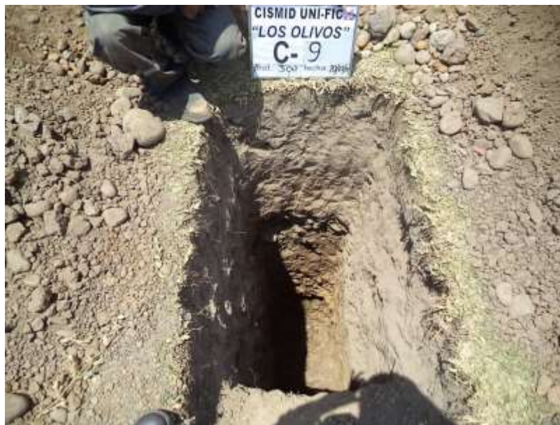
FOTO 18: En la calicata C-09, de 0.00 a 0.30 m se tiene terreno de cultivo; de 0.30 a 1.00 m arcilla delgada (CL); de 1.00 a 1.20 m bolonería con arena; de 1.20 a 2.00 m arcilla delgada con arena; de 2.00 a 3.00 m grava mal gradada con arena (GP).
