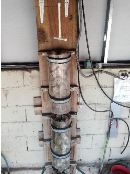
Foto N° 26: Distribución de las esponjas en el Módulo 01 y Módulo 02 – Día 15/02/2019
