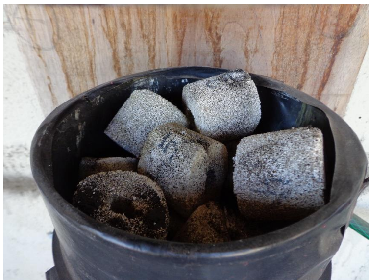
Foto N° 57: Esponjas endurecidas en el Módulo 01
