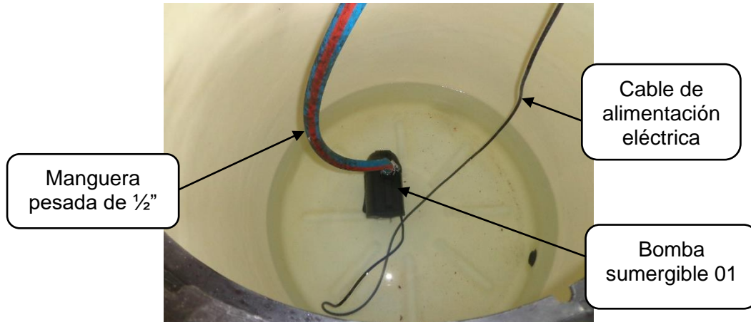
Foto N° 2: Vista en planta de la Bomba sumergible al interior del tanque de almacenamiento
