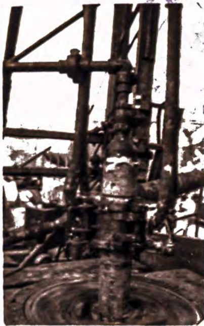
Cabezal simple de cementación instalado en la sarta de tubería.
