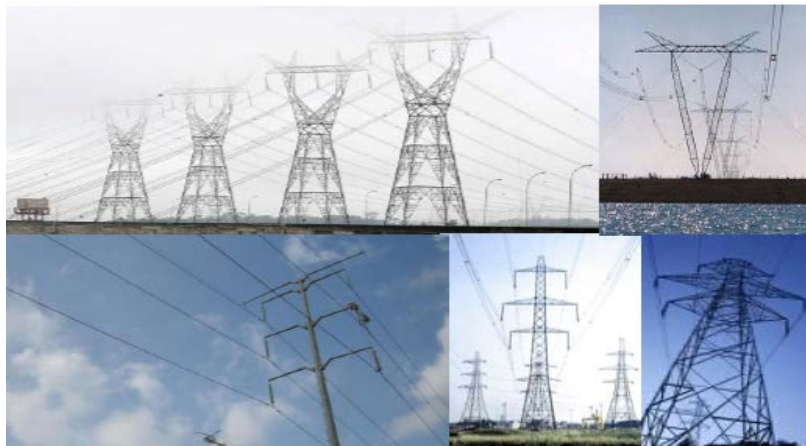
Fig. 2.1 Líneas de transmisión.
