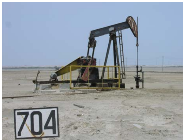
FIGURA I-4 UNIDAD DE BOMBEO MECANICO SOBRE SUELO - NOROESTE
