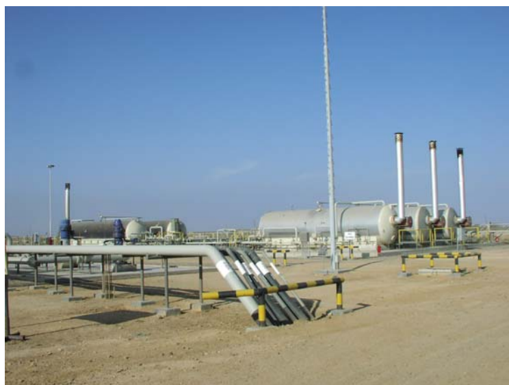
FIGURA I-5 INFRAESTRUCTURA (FACILIDADES) INSTALADA - NOROESTE
