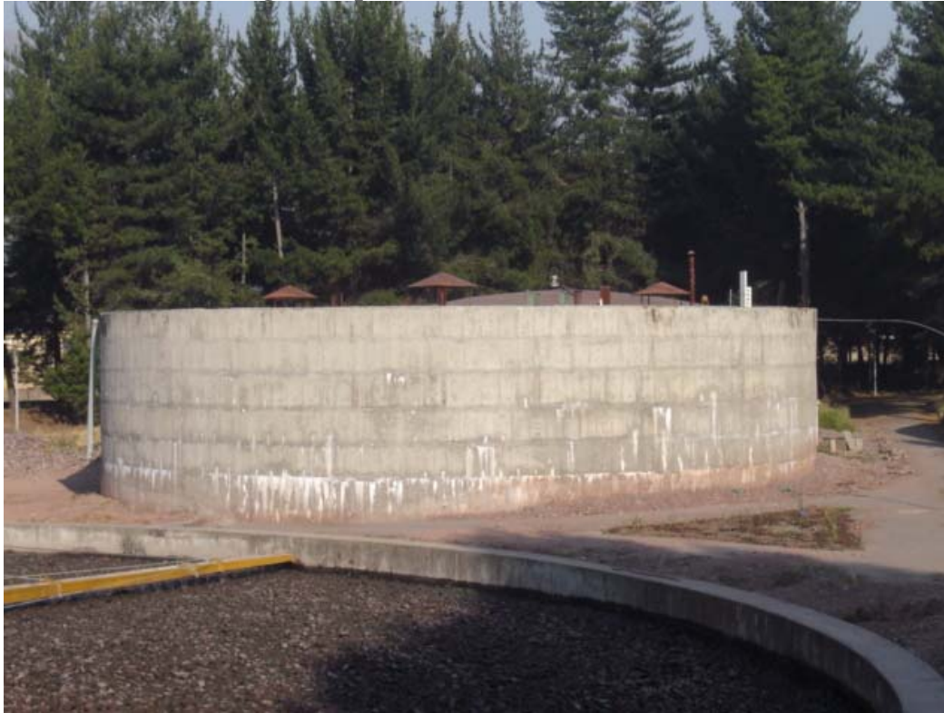
Foto 7 PTAR: digestor de lodos
