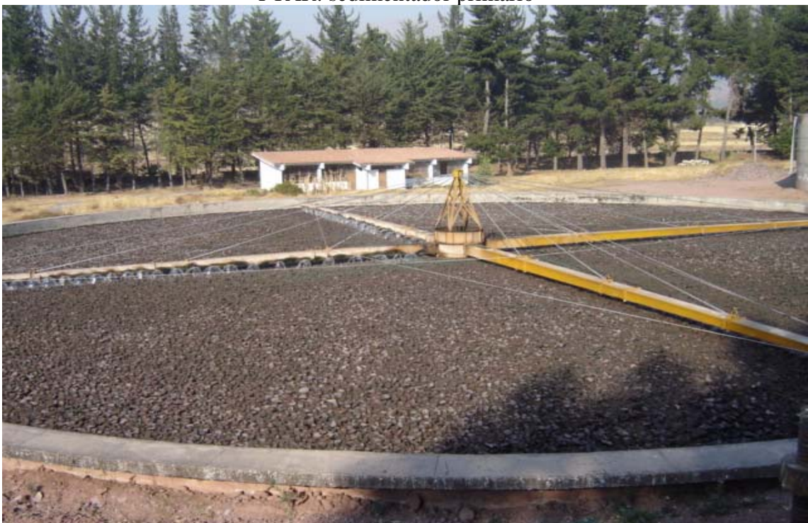
Foto 6 PTAR: filtro percolador
