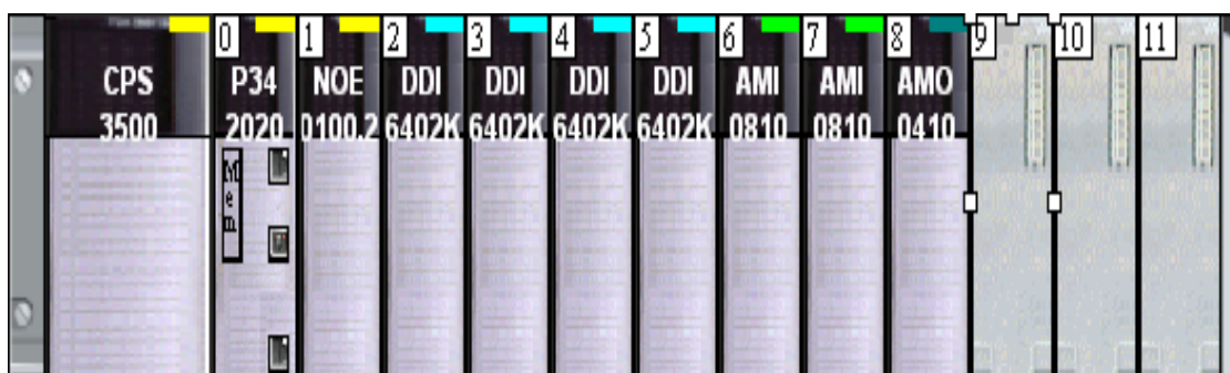
Figura 2.7: Estación de control
