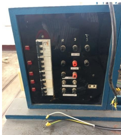
Figura III.5. Tablero de conexiones de la Mesa de trabajo.
