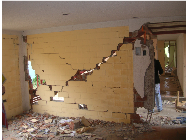
Figura 1.2. Falla por corte de un muro de albañilería confinada
