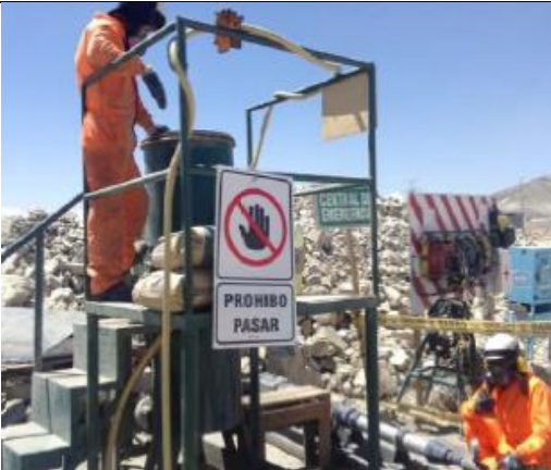
Central de Inyección
