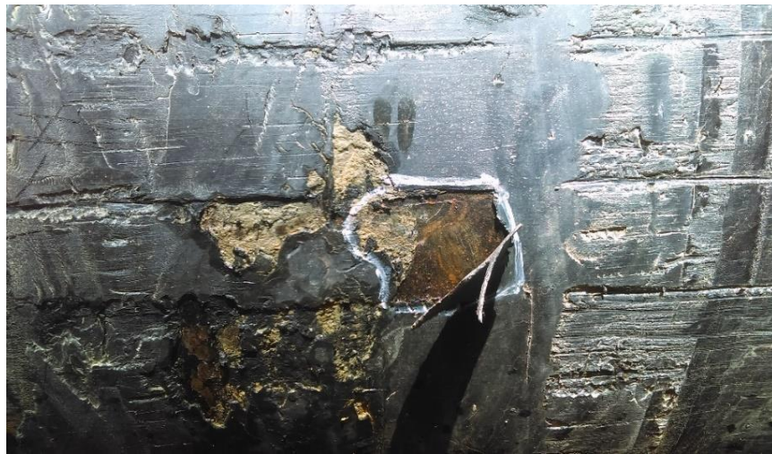
Figura 13: Daño tipo D a la tubería de fluido GN
