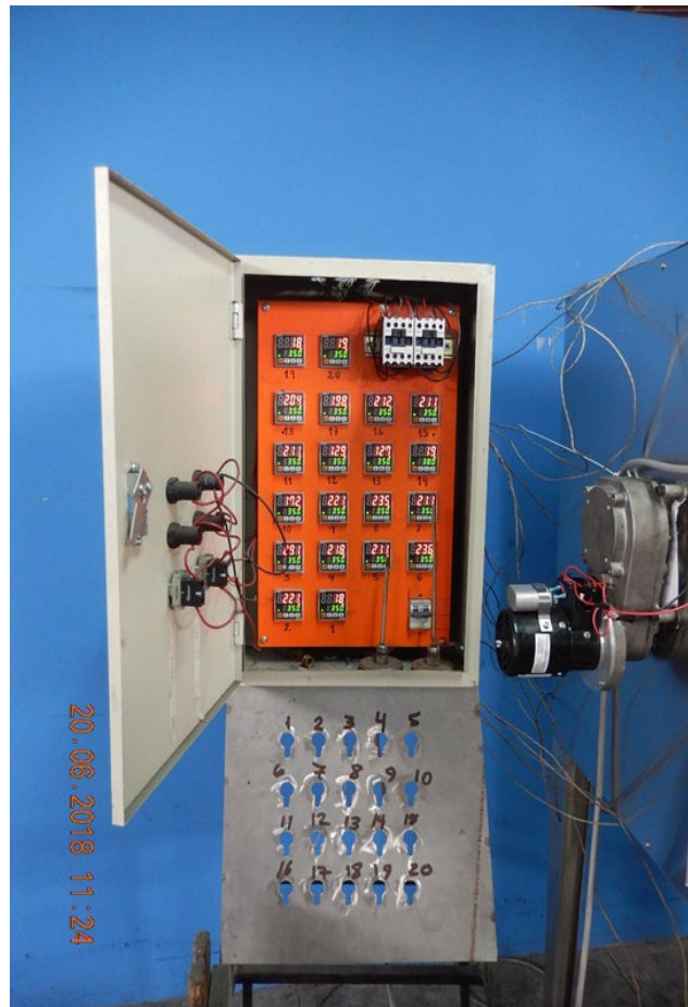
Figura 3.2. Tablero eléctrico conteniendo 20 termocuplas.
