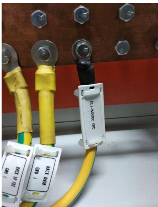
Figura 4.19 Conexión de cable tierra (GND) a la barra de tierra
