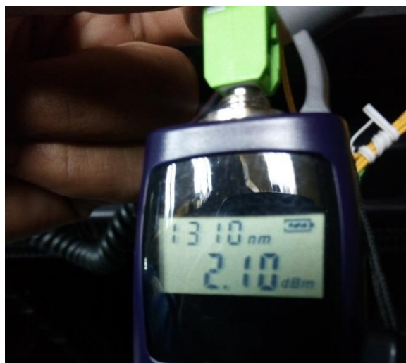
Figura 4.41 Medición de potencia óptica de las señales de televisión en el enlace primario
