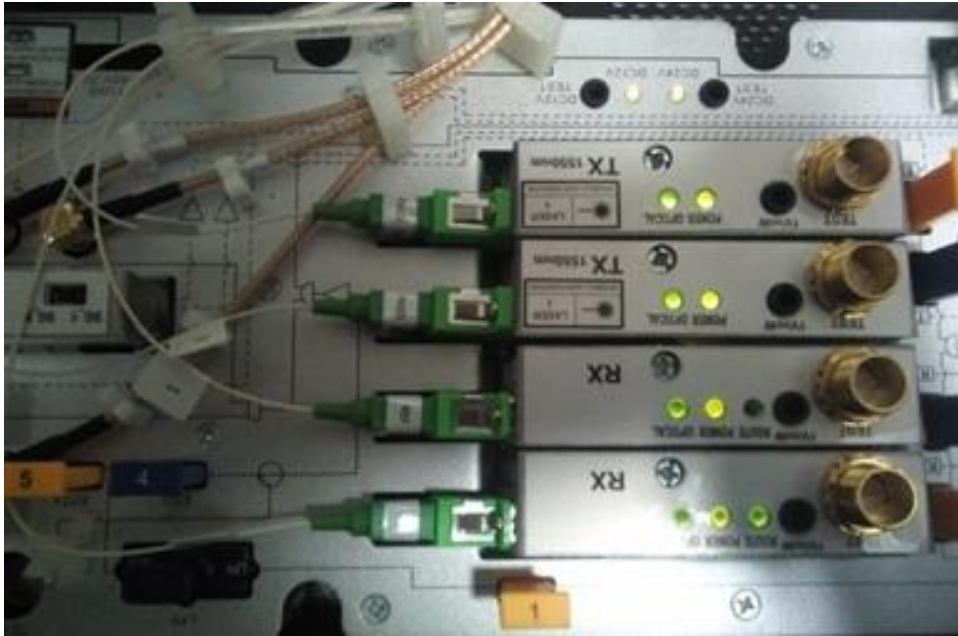
Figura 4.29 Cableado de fibras ópticas en módulos Transmisor y Receptor Óptico
