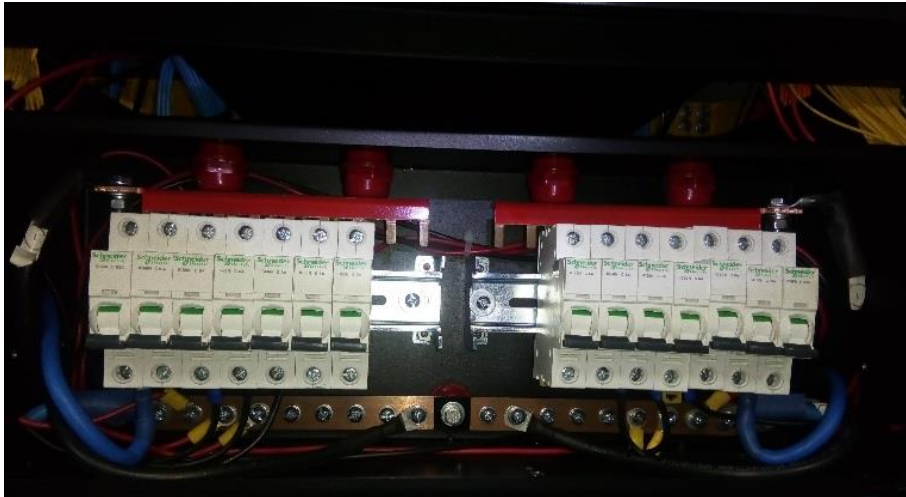
Figura 4.20 Fuente de energía lado A y B
