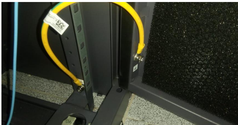
Figura 4.18 Aterramiento del gabinete
