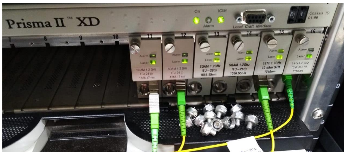
Figura 4.14 Cableado de fibras ópticas en la fuente de televisión
