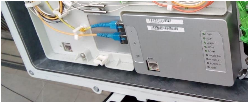
Figura 4.28 Cableado de fibras ópticas en el módulo Red Óptica Pasiva de capacidad Gigabit (GPON)
