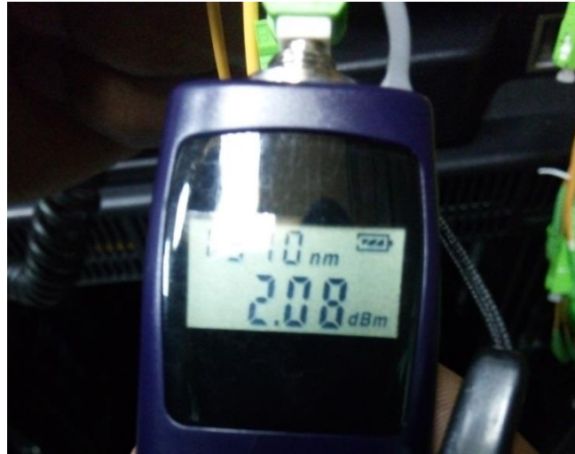
Figura 4.42 Medición de potencia óptica de las señales de televisión en el enlace de protección
