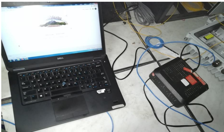
Figura 4.59 Laptop conectada al terminal cable modem
