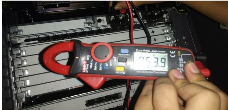
Figura 4.22 Medición de voltaje en el componente principal de energía H901PILA
