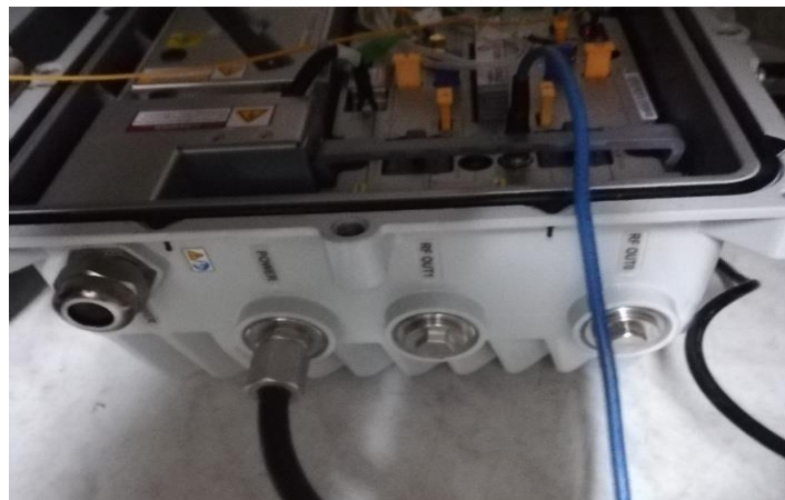
Figura 4.27 Cableado coaxial al puerto energía (POWER) con conector tipo F
