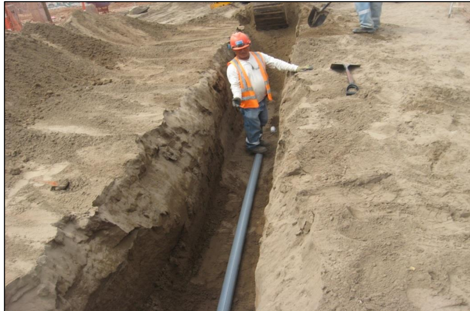
FOTO N°23: Instalación de tubería, excavación tipo I en red de agua potable (TI-003).
