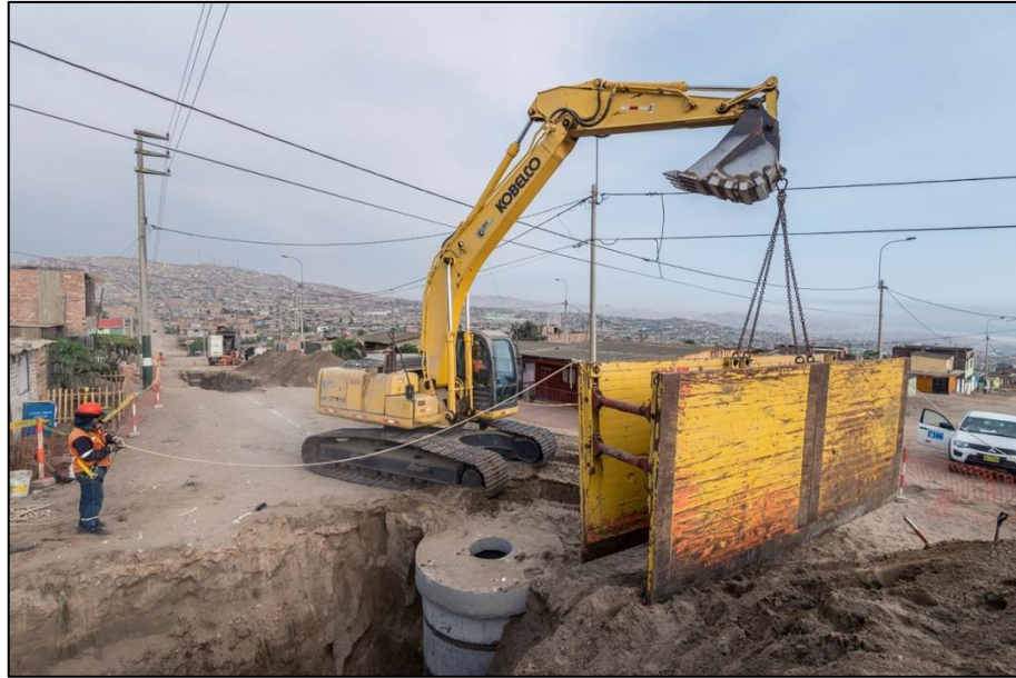
FOTO N°13: Necesidad de usar equipos pesados para mover entibados (camión grúa o excavadora)
