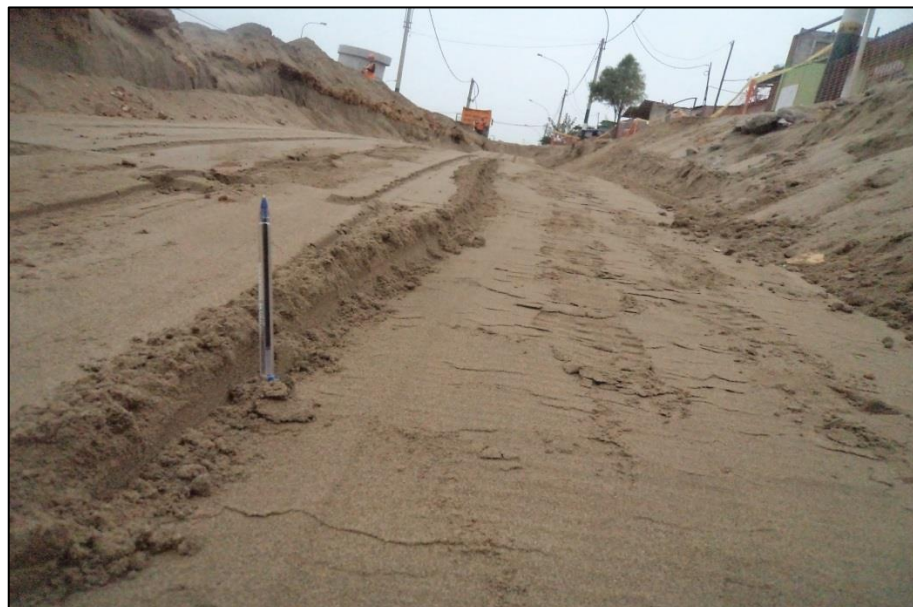
FOTO N°49: Efecto de la Precompactación con plancha vibratoria en aplicación de excavación tipo III en red de alcantarillado (TIII-002).
