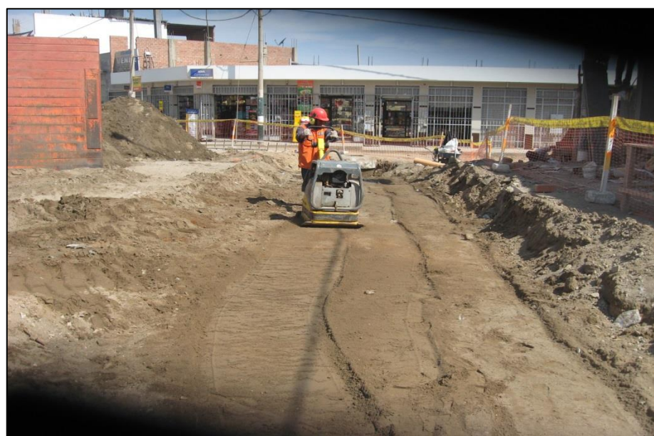
FOTO N°32: Precompactación con plancha vibratoria previo a la excavación tipo II en red de alcantarillado (TII-001).
