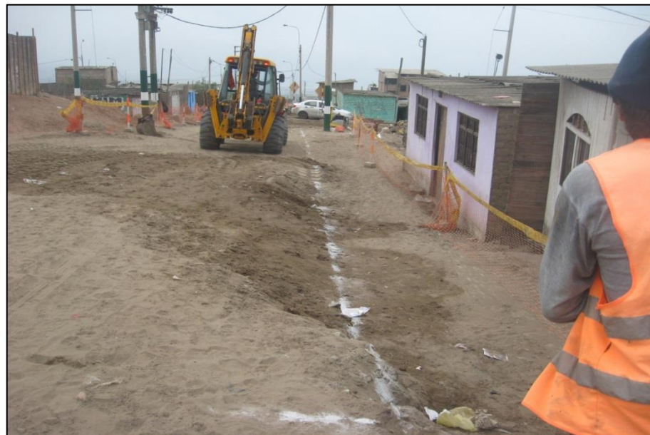
FOTO N°20: Aplicación de excavación tipo I en red de agua potable, trazo de eje (T-003).
