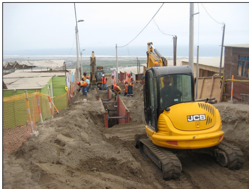
Fig.N°05: Entibados y falta de espacio
