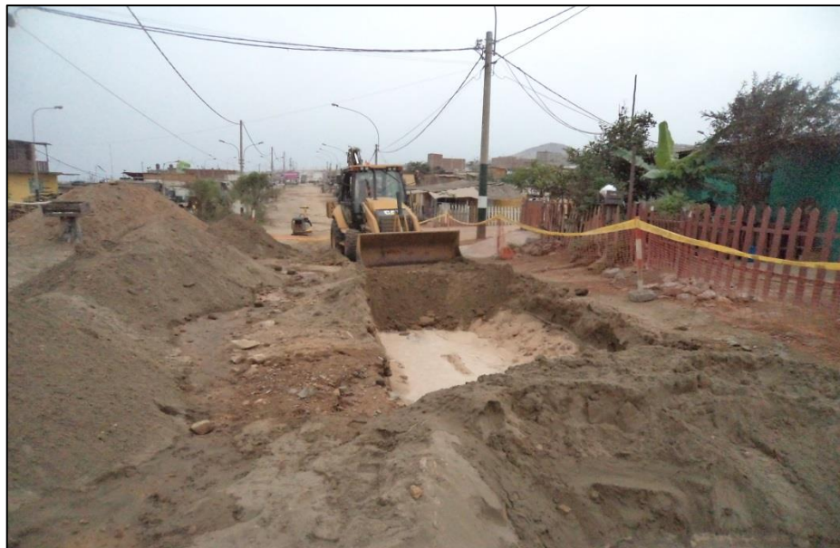
FOTO N°47: Demolición y nivelación de arroceras, excavación tipo III en red de alcantarillado (TIII-002).
