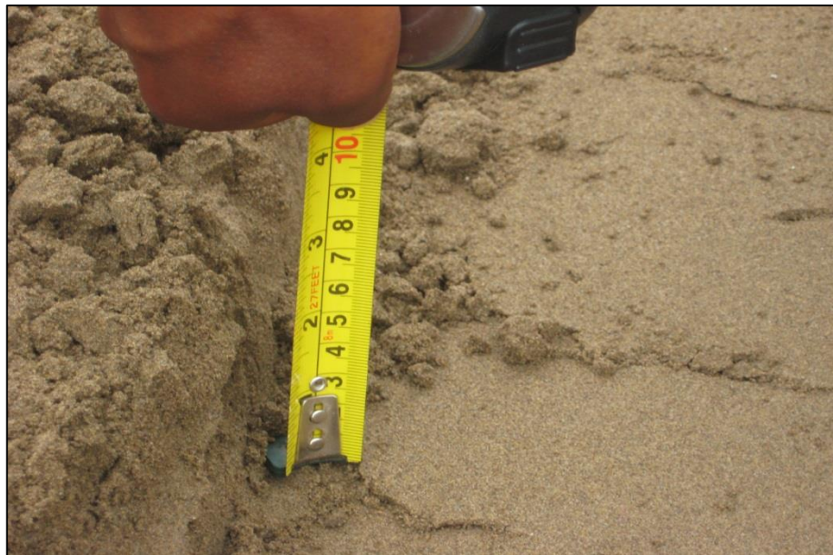
FOTO N°38: Efecto de la precompactación con plancha vibratoria previo a la excavación tipo II en red de alcantarillado, hundimiento de 10cm (TII-002).
