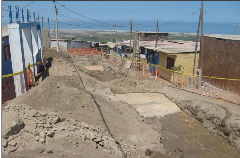
FOTO N°41: Arroceras en aplicación de excavación tipo II en red de alcantarillado (TII-003).
