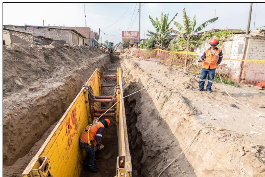
FOTO N°10: Sobre excavación a pesar del uso de entibado.
