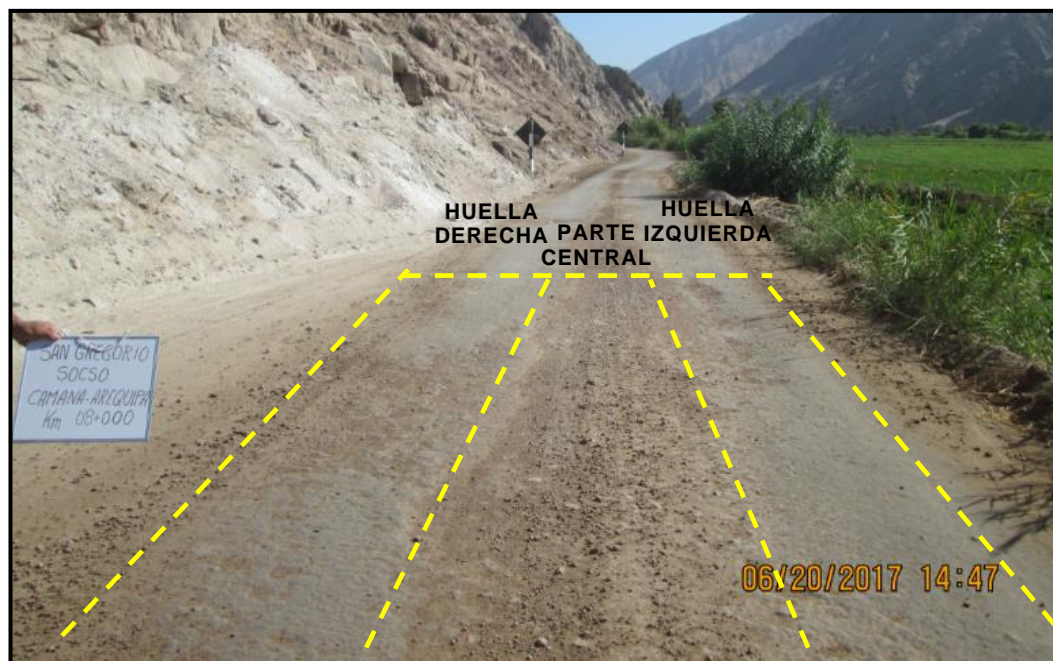
Figura N° 70 Desgaste de la capa de rodadura en la huella derecha, izquierda y parte central.
