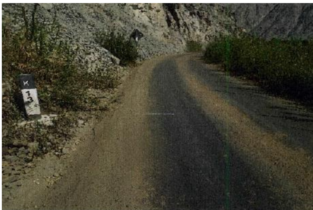
Figura N° 101 Vista hacia atrás del Km 13+000, foto tomada a los 14 meses de haberse rehabilitado el camino. (02-09-2015)
