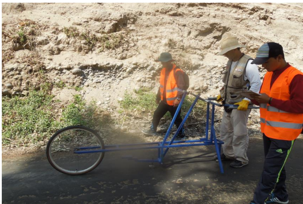
Figura N° 132 Medición de la rugosidad empleando el equipo MERLIN. Prog.km 11+500, foto tomada a los 22 meses de haberse rehabilitado el camino (16-05-2016)
