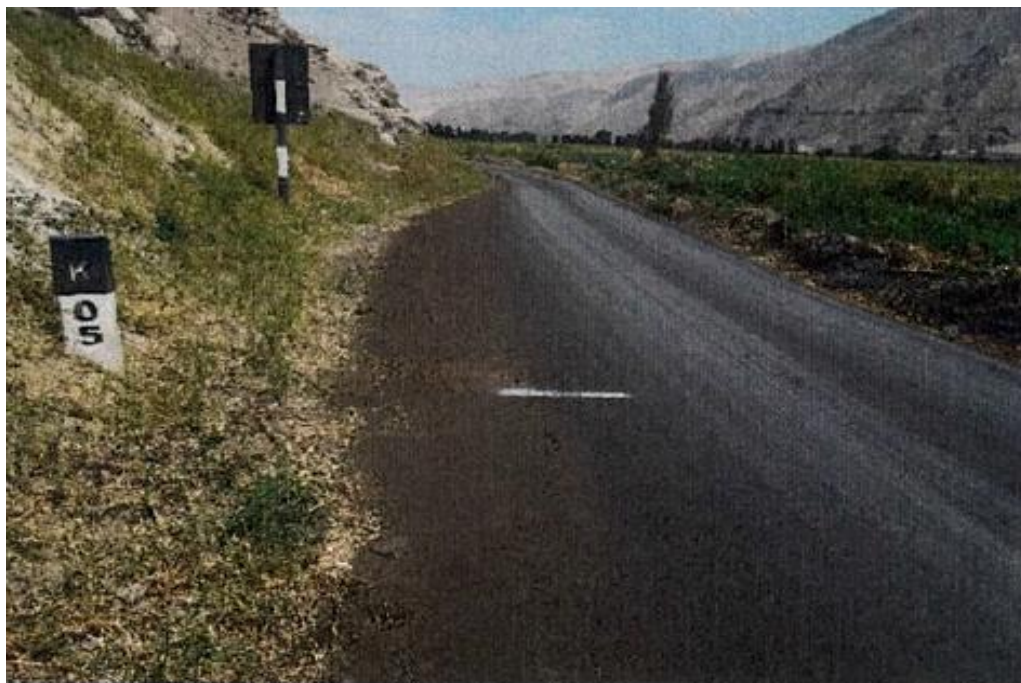
Figura N° 93 Vista hacia atrás del Km 05+000, foto tomada a los 14 meses de haberse rehabilitado el camino. (02-09-2015)
