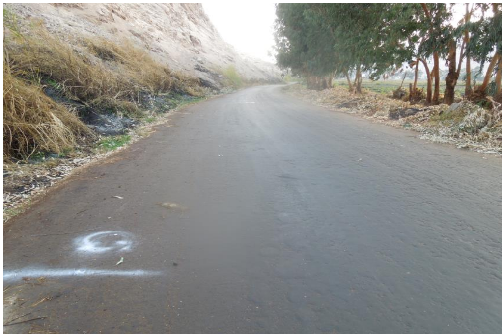
Figura N° 105 Vista hacia atrás del Km 06+000, foto tomada a los 22 meses de haberse rehabilitado el camino. (16-05-2016)
