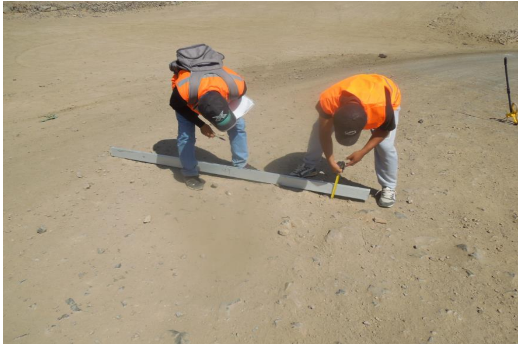
Figura N° 127 Medición de la falla superficial perdida de agregado. Prog.km 14+700, foto tomada a los 22 meses de haberse rehabilitado el camino (16-05-2016)
