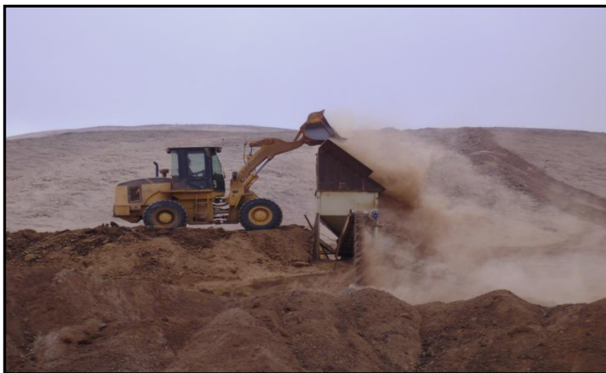
Figura N° 35 Máquina “zaranda mecánica” instalada dentro de la cantera
