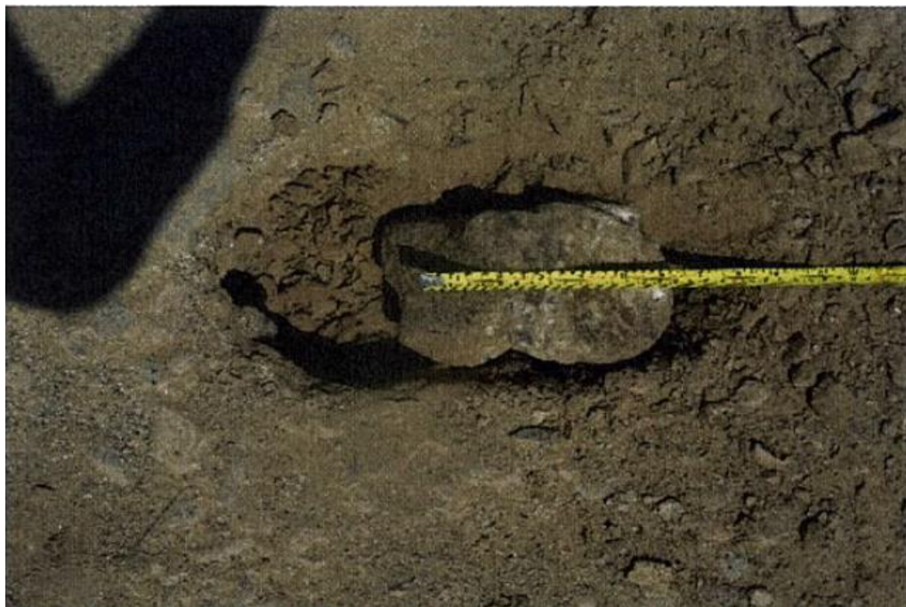
Figura N° 129 Piedra perteneciente a la capa de rodadura mayor a 6". Prog.km 15+210, foto tomada a los 14 meses de haberse rehabilitado el camino (02-09-2015).
