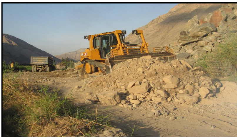
Figura N° 34 Ensanche de la plataforma con un tractor sobre orugas en la Prog. 21+800
