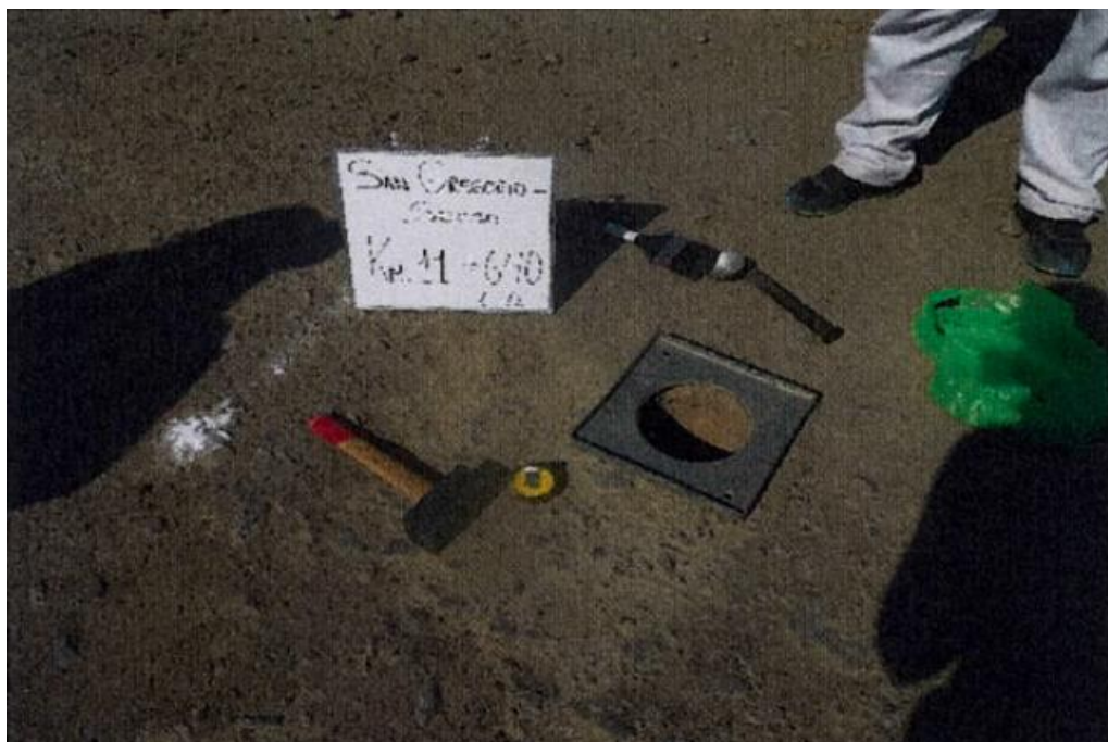
Figura N° 136 Extracción de muestra y ensayo de densidad de campo. Prog.km 11+640, foto tomada a los 14 meses de haberse rehabilitado el camino San Gregorio Socso (02-09-2015).
