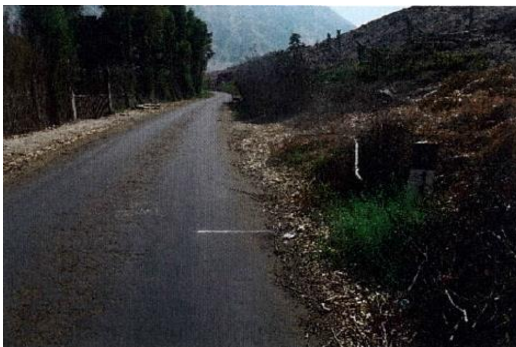
Figura N° 99 Vista hacia adelante del Km 11+000, foto tomada a los 14 meses de haberse rehabilitado el camino. (02-09-2015)
